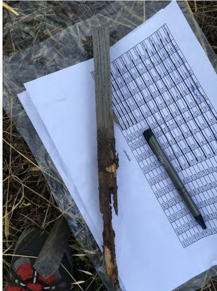
Şekil 42. Çanakkale’de gerçekleşen termit degradasyonu
