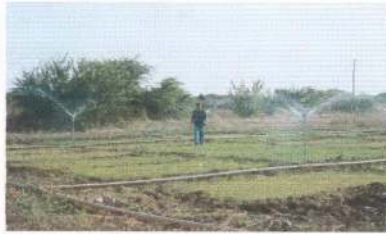
Şekil 3.19. Yağmurlama sulama sistemi.
