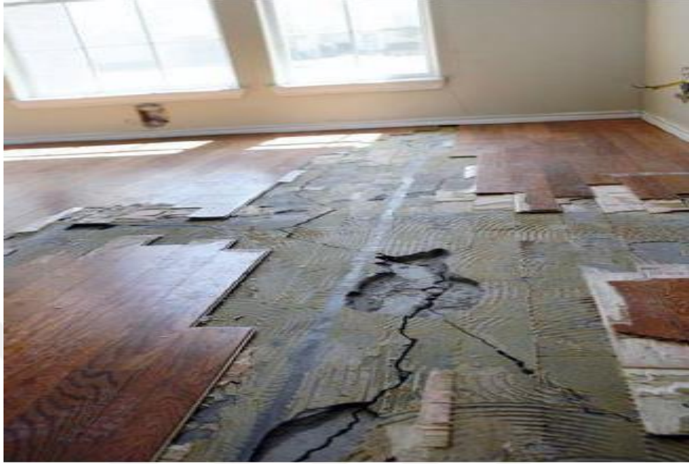
Şekil 2.2. Şişen zemin nedeniyle zemin katta oluşan hasar
