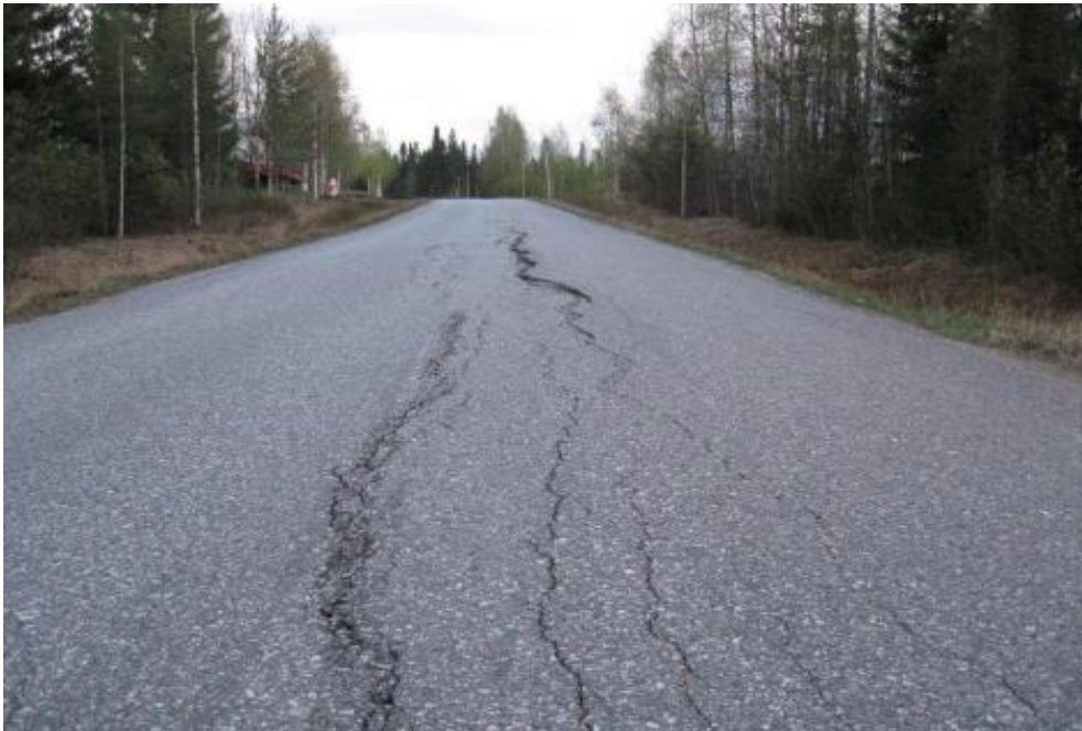
Şekil 2.3. Şişen zemin nedeniyle zarar gören asfalt yol
