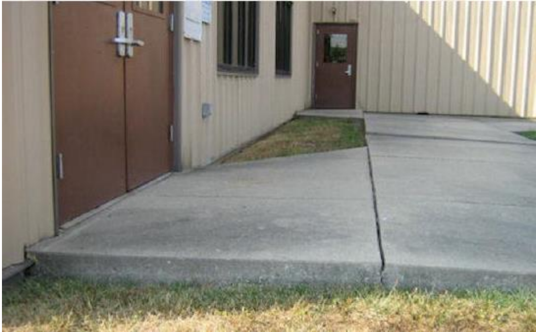
Şekil 2.1. Endüstriyel binanın bitişiğindeki beton levhaların kabarması
