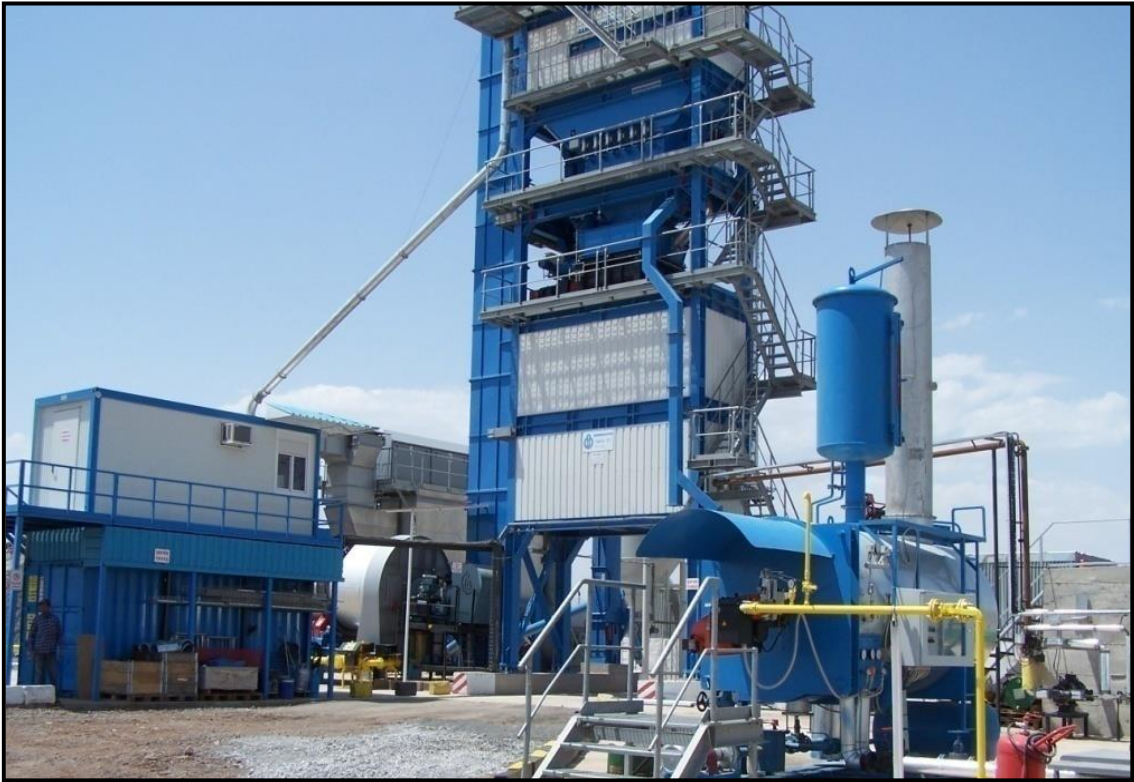
Şekil.5.2. Harman tipi asfalt plant tesisi.
