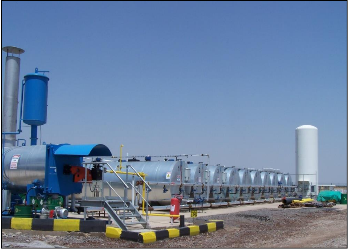
Şekil.5.3. Asfalt plant tesisi bitüm ve kızgın yağ üniteleri.
