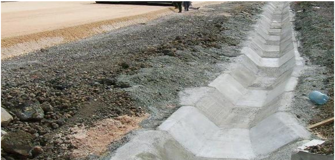
Şekil 3.21. Yağmur Suyu Drenajını Sağlıycak Beton Hendek
