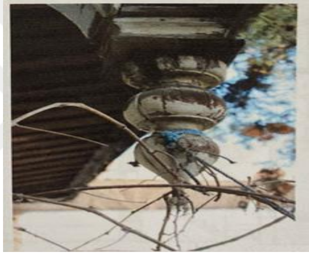
Şekil 5. 84. Balkonda çatıdan sarkıtılmış ahşap süslemeler [76]
