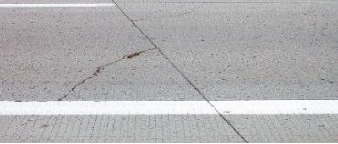
Şekil 1. Derz bölgesinde oluşan köşe çatlağı (URL-2)
