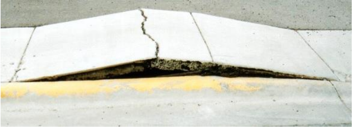
Şekil 2. Beton kaplamada oluşan ısı genleşme çatlağı (URL-5)
