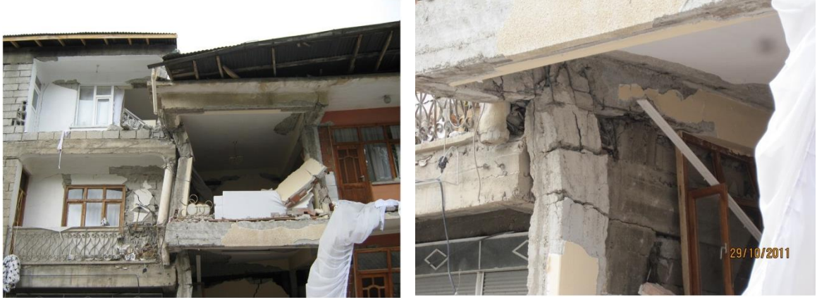
a. 23 Ekim 2011 Van depremi sonrası gözlemlenen çarpışma hasarları (Korkmaz, 2015)
