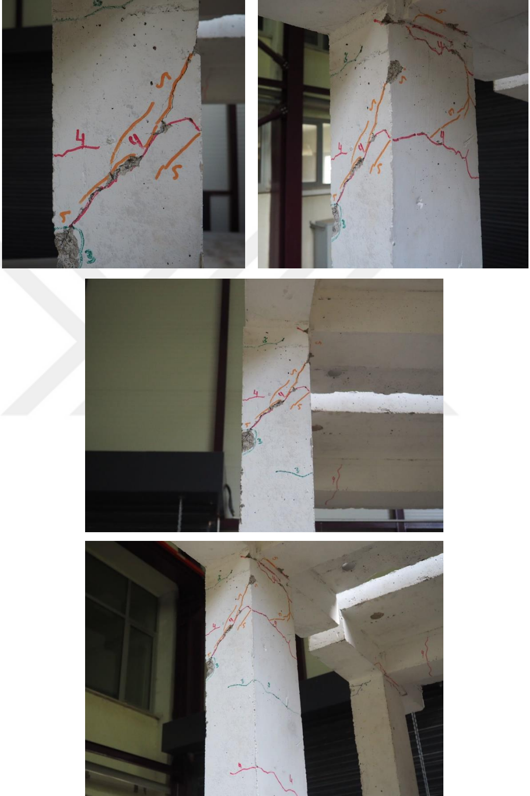
b. %100 Parkfield depremi sonrasında 2. kat kolonunda çarpışma nedeniyle oluşan kesme hasarları
