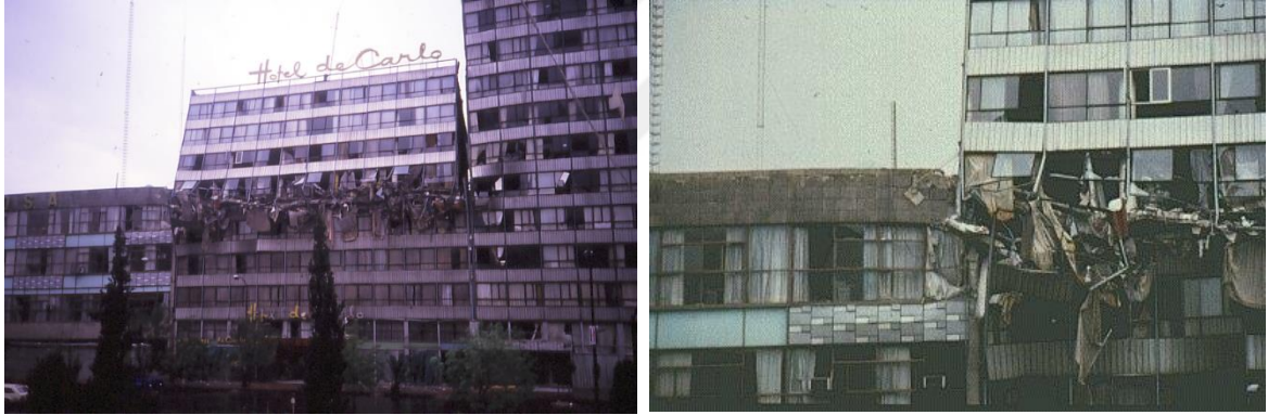
Şekil 1.9. Farklı yüksekliğe sahip komşu binaların çarpışması nedeniyle oluşan hasarlar (URL-1; URL-2)
