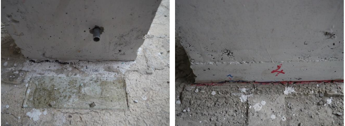
b. Sarsma masası deneyleri sonrasında temel-1. kat kolon ve 1. kat döşeme-2. kat kolon arayüzlerinde meydana gelen ayrılmalar
