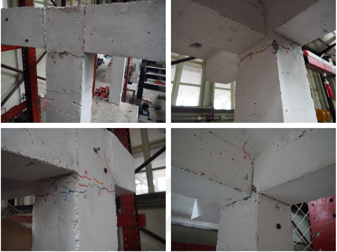
a. Sarsma masası deneyleri sonrasında kolon üst uçlarında ve birleşim bölgelerinde işaretlenen hasarlar
