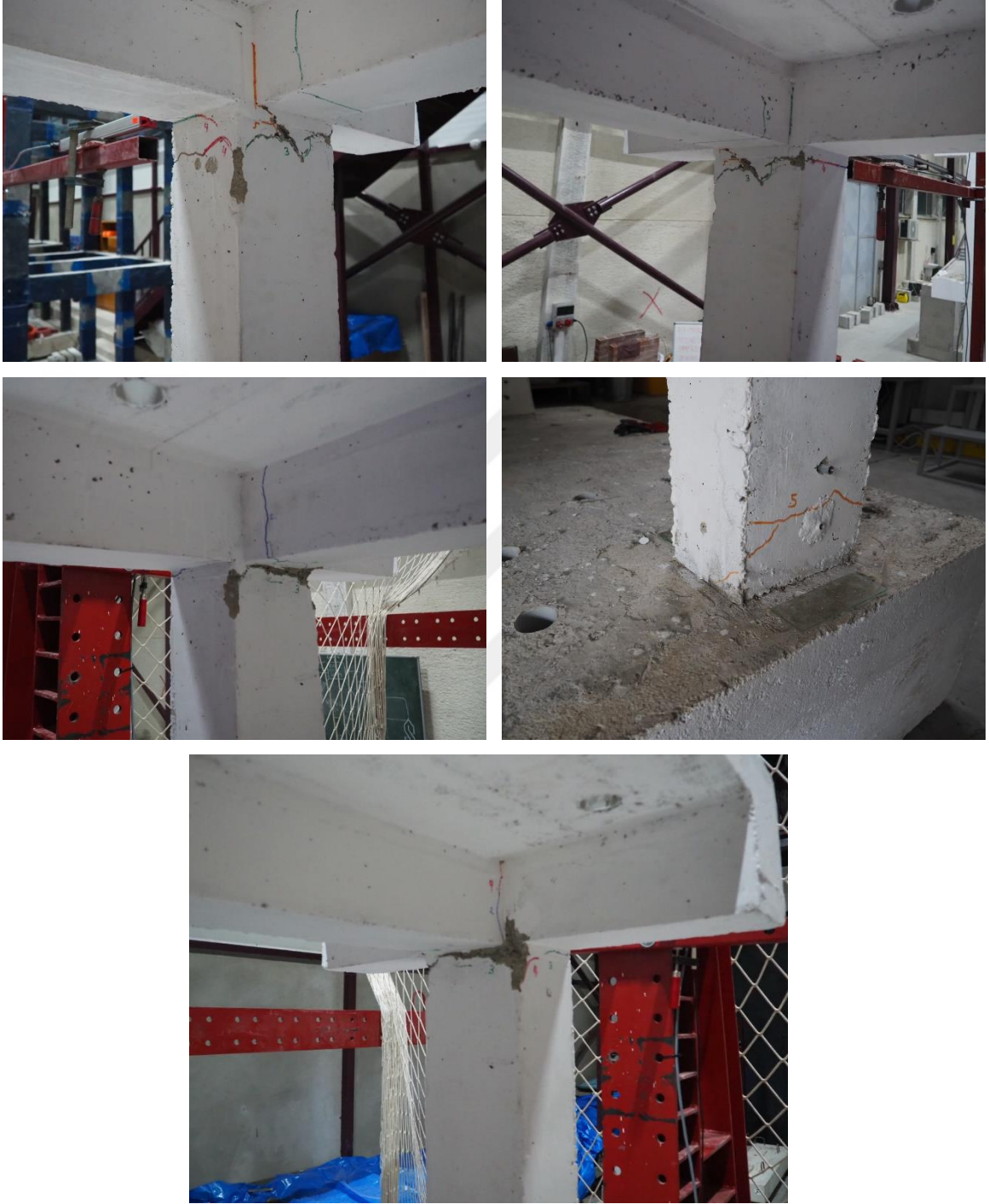
d. %100 Parkfield depremi sonrası kolon uçlarında ve birleşim bölgelerinde oluşan yeni çatlaklar ve mevcut çatlaklardaki ilerlemeler
