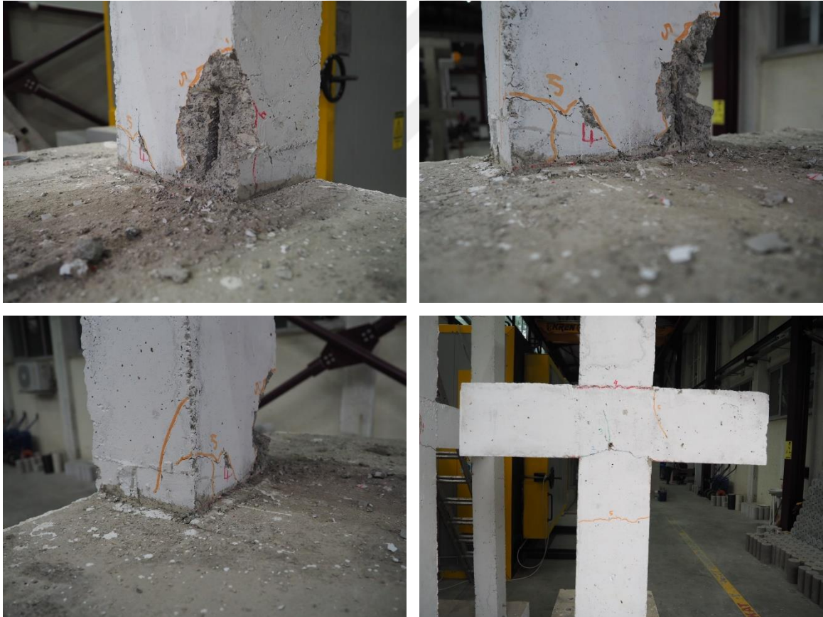
a. %100 Parkfield sonrasında 2. kat kolon alt ucunda çarpışma nedeniyle oluşan hasarlar
