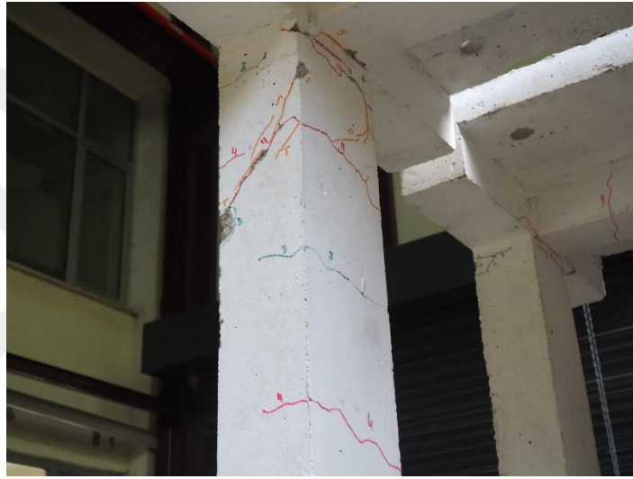
b. Kolon-döşeme etkileşiminin incelendiği deneylerde çarpışma nedeniyle kolonda meydana gelen hasarlar
