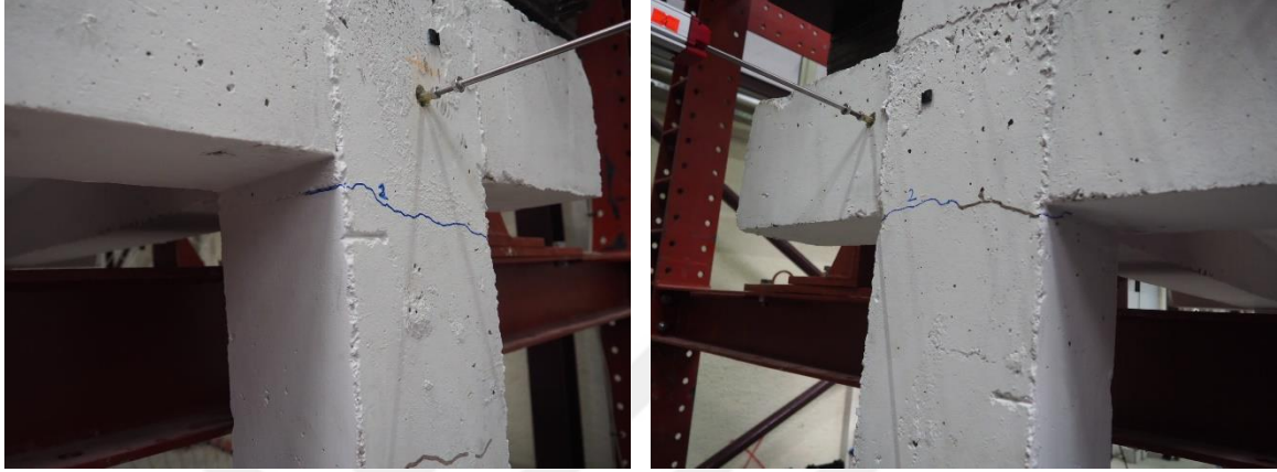
a. %50 Erzincan depremi sonrası kolon üst uçlarında oluşan çatlaklar
