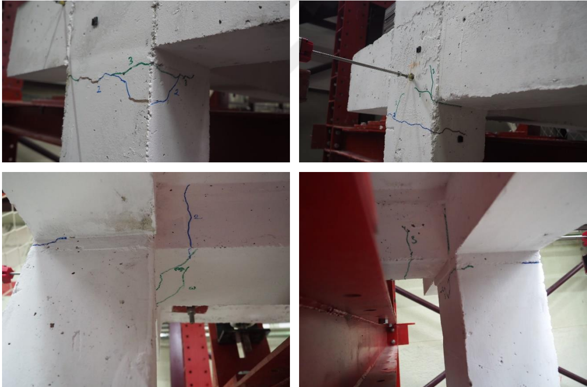
b. %75 Erzincan depremi sonrası kolon üst uçlarında, birleşim bölgelerinde ve giriş uçlarında oluşan çatlaklar
