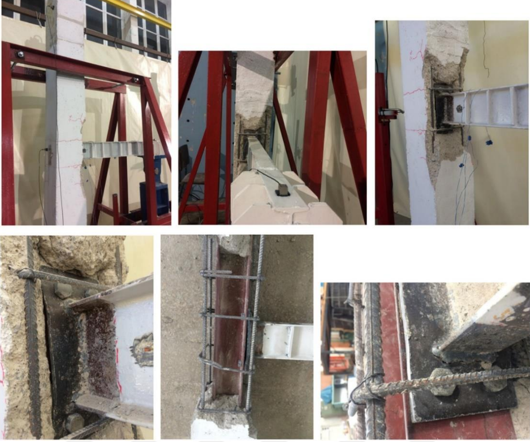
Şekil 2.58. ‘a’ tipi birleşim bölgesi sistemde tersinir-tekrarlanır yükleme sonrası meydana gelen hasar durumu (Hüsem ve diğ., 2018)
