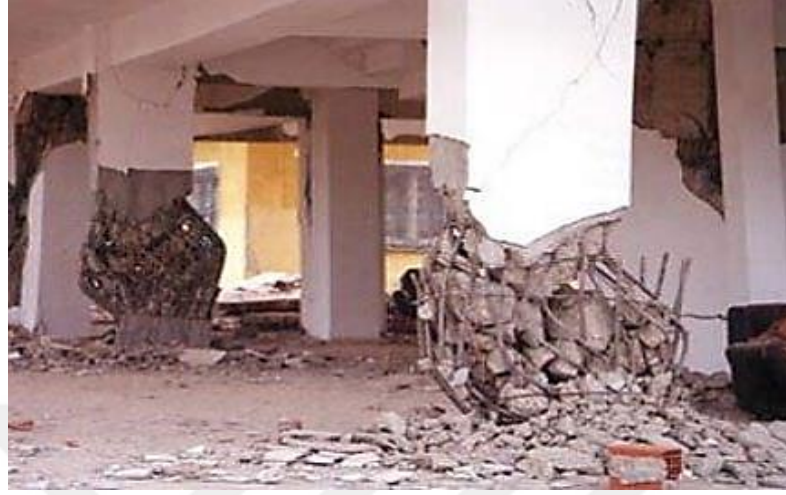
řekil 3.3. Burulma etkisinde kolonlarda hasar durumu (Kurt, C.)
