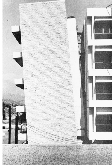
Şekil 4. 1971 San Fernando depreminde meydana gelen çarpışma sonucu merdiven kulesinin kalıcı deformasyonu (Bertero vd., 1973; Jankowski, 2009)
