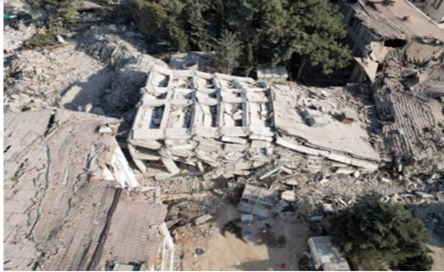
Şekil 2.3. Yönetmeliğe uygun tasarlanmamış bir yapı [30]
