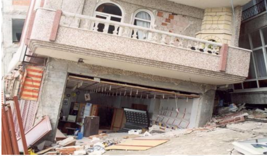
Şekil 2.7. Uygun olmayan bir zeminde yapılmış yapı [39]
