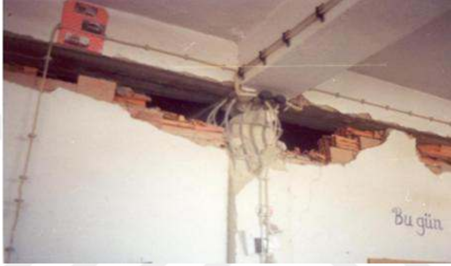
Şekil 2.4. Kolon-kiriş birleşim bölgesi hasarı
