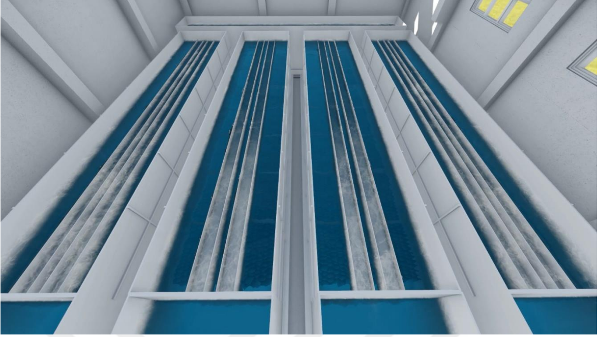
Şekil 16:Arıtma Binası İçerisinde Bulunan Durultucu Ünitesi
