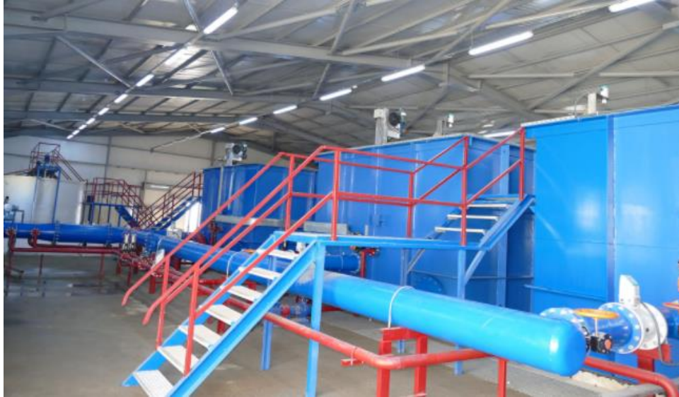
Şekil 7: Trabzon Karakaya İçmesuyu Arıtma Tesisi -1 [www.trabzon.bel.tr]
