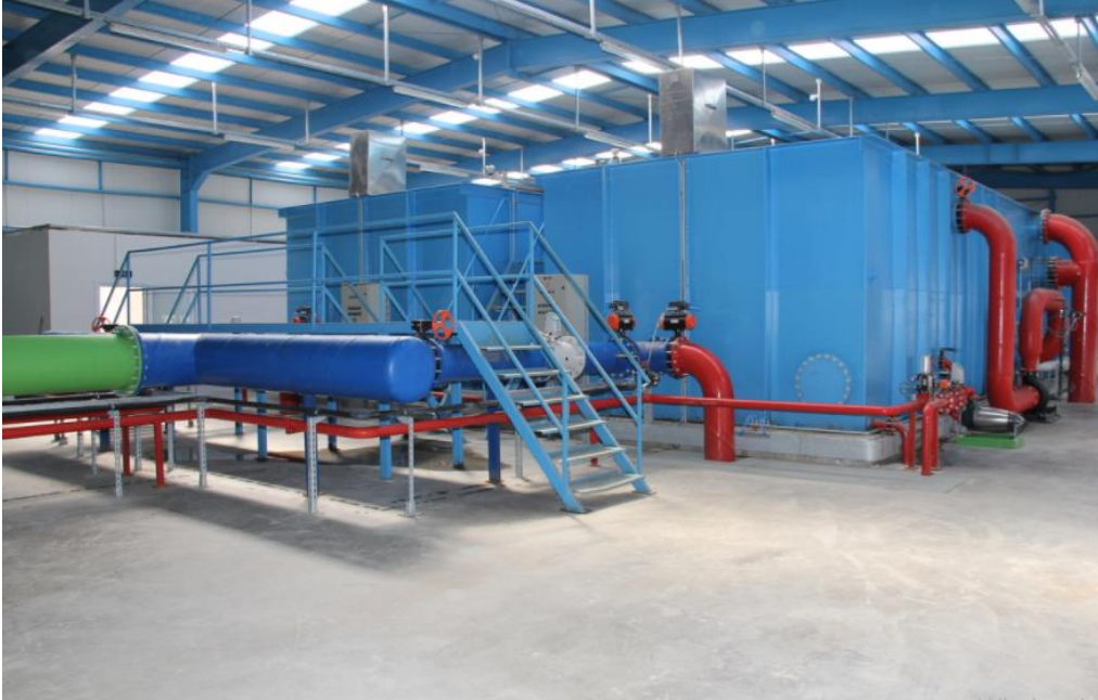
Şekil 9: Karapürçek İçmesuyu Arıtma Tesisi -1
