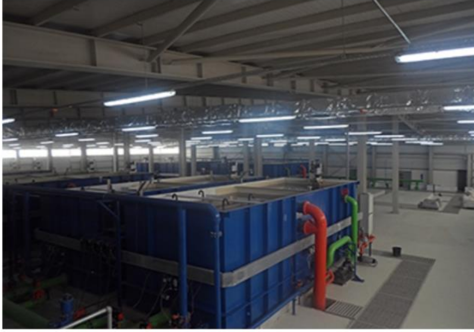
Şekil 6: Türkmenistan Serdarabat/Lebap İçmesuyu Arıtma Tesisi [www.hazarsu.com]
