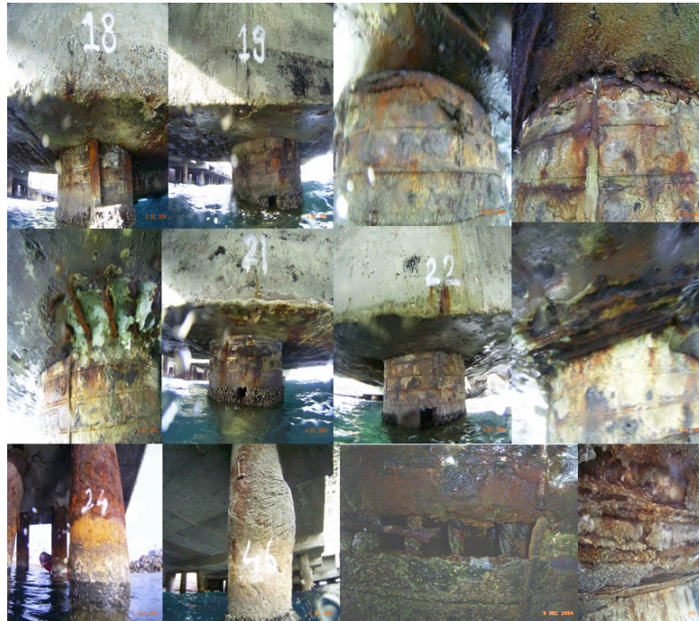
Şekil 5.2 Rehabilitasyon ve güçlendirme gereken kazıklar
