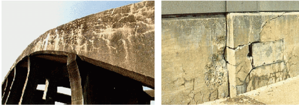
Şekil 3.6 ASR hasarına uğramış yapı örnekleri
