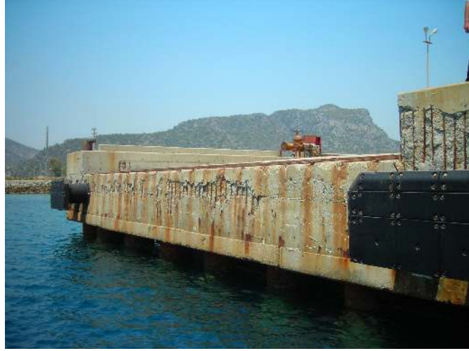
Şekil 5.18 Kapak atma rampası alın kirişlerinde donatı korozyonu
