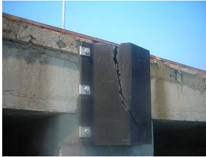
Şekil 5.19 Hasarlı usturmaça örneği
