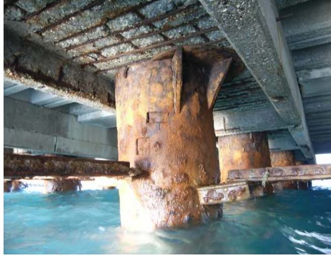
Şekil 5.13 Başlık içine düzgün oturmeyan ve donatı yerleşimi şüpheli olan kazık örneği
