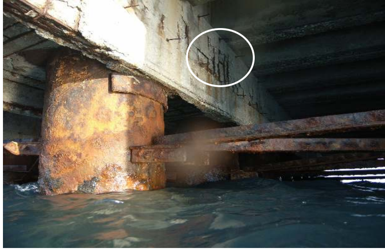
Şekil 5.15 Başlık kirişi betonunda dökülme ve donatılarda korozyon
