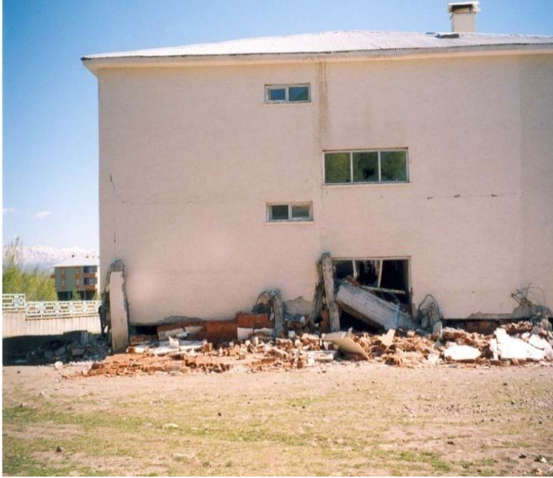
Resim 1.4. Yapının diğer yöndeki dış cephesinde düğüm bölgesinden çıkan kolon
