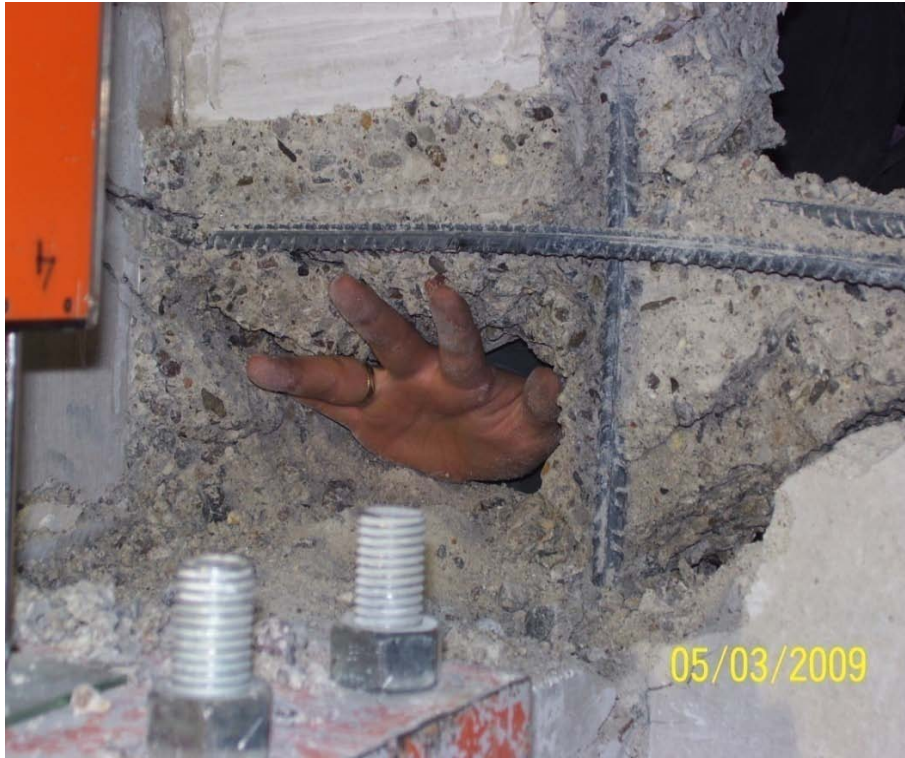
Resim 3.18. WC2d elemanında düğüm betonunun ezilerek dökülmesi
