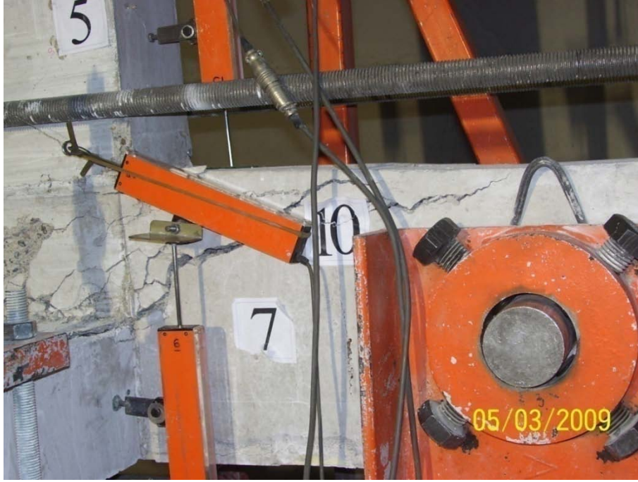
Resim 3.17. WC2d elemanında alt kolonda oluşan hasar
