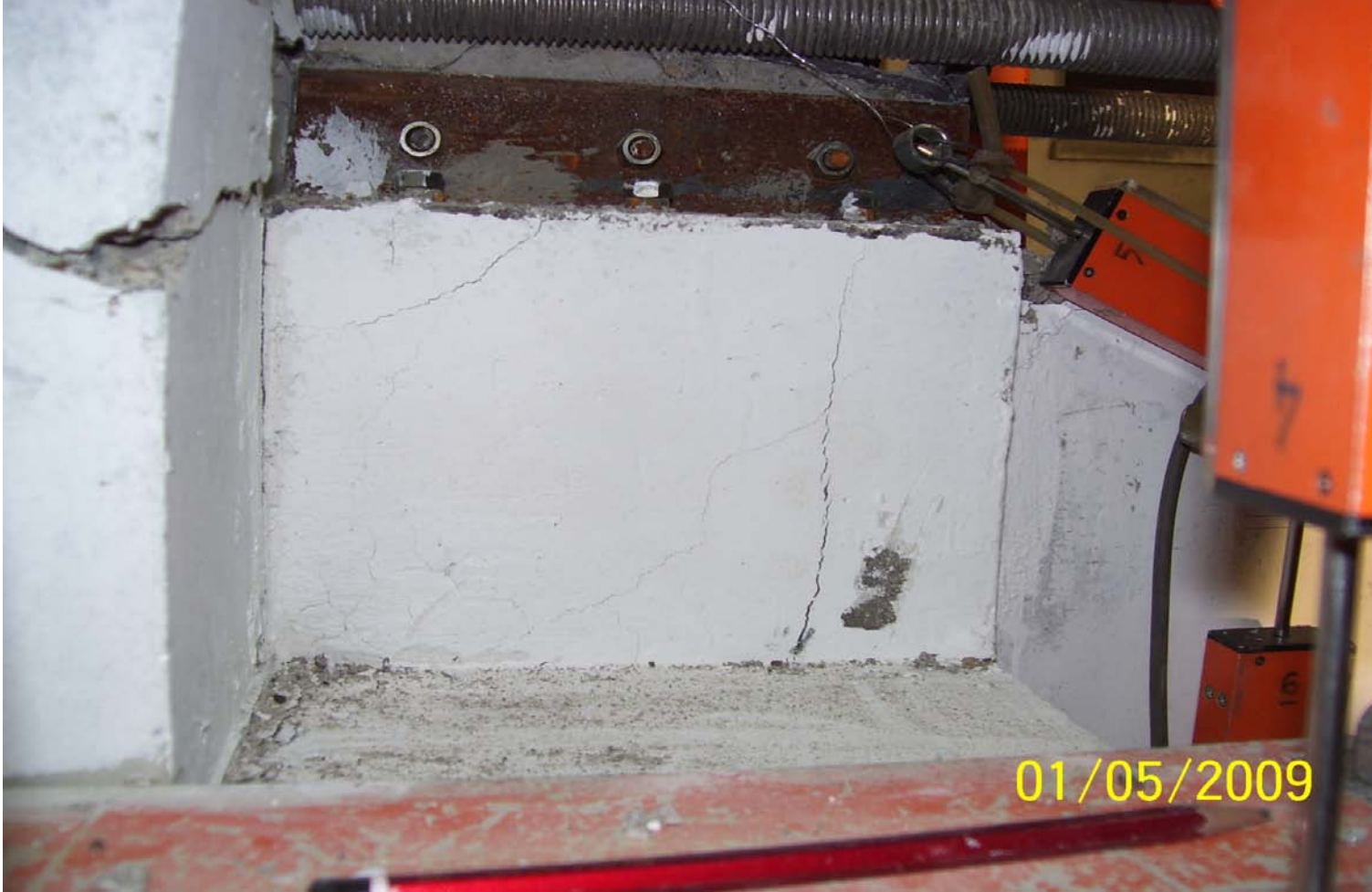
Resim 4.31. C2 elemanı düğüm bölgesinin deney sonundaki görünüşü
