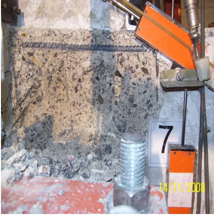
Resim 4.23. A2 elemanında oluřan düğüm bölgesi hasarı
