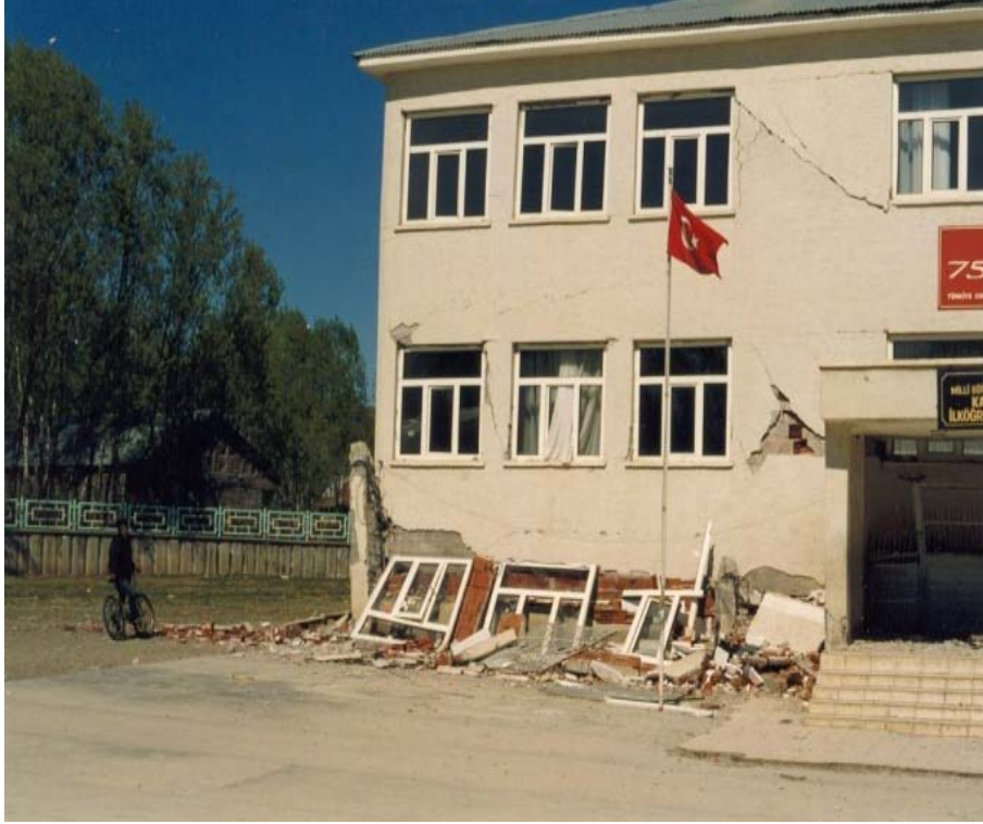
Resim 1.1. Depremde yapının dış cephesinde düğümden ayrılan kolon
