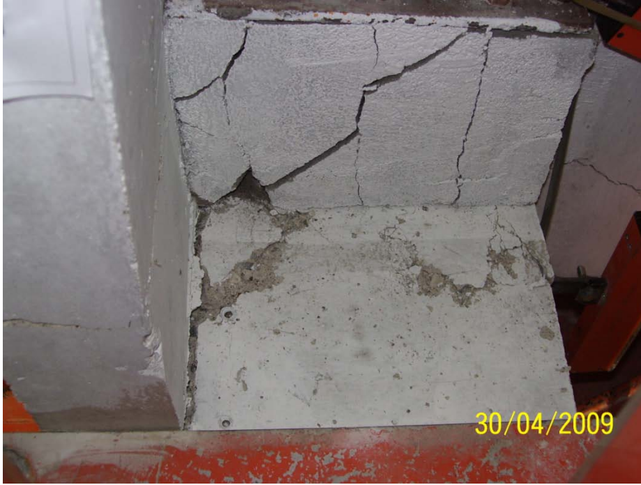
Resim 3.30. E1 elemanında somun sıyrılmasına bağlı olarak birleşim bölgesinde oluşan hasarlar
