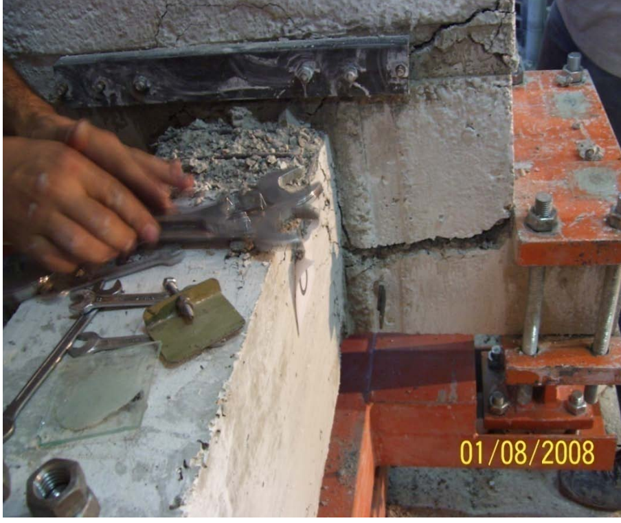
Resim 3.21. A1 elemanında ana kirişte plastik mafsal oluşmasıyla döşemede görülen çatlaklar
