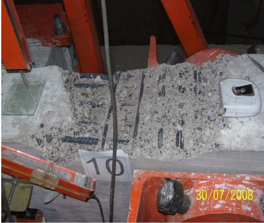
Resim 3.15. WC1c elemanında alt kolon iç yüz pas payı betonunun dökülmesi
