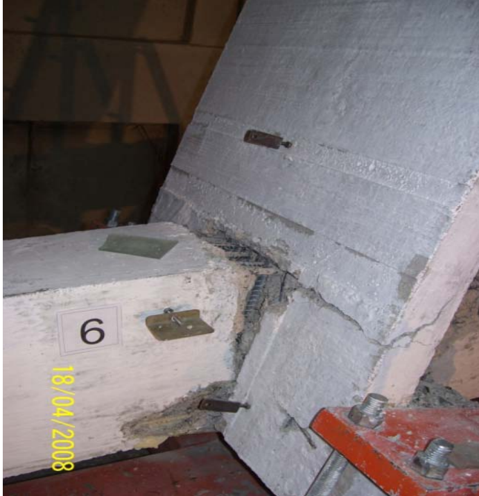
Resim 3.12. WC1b elemanı üst kolonun döşemeden ayrılması
