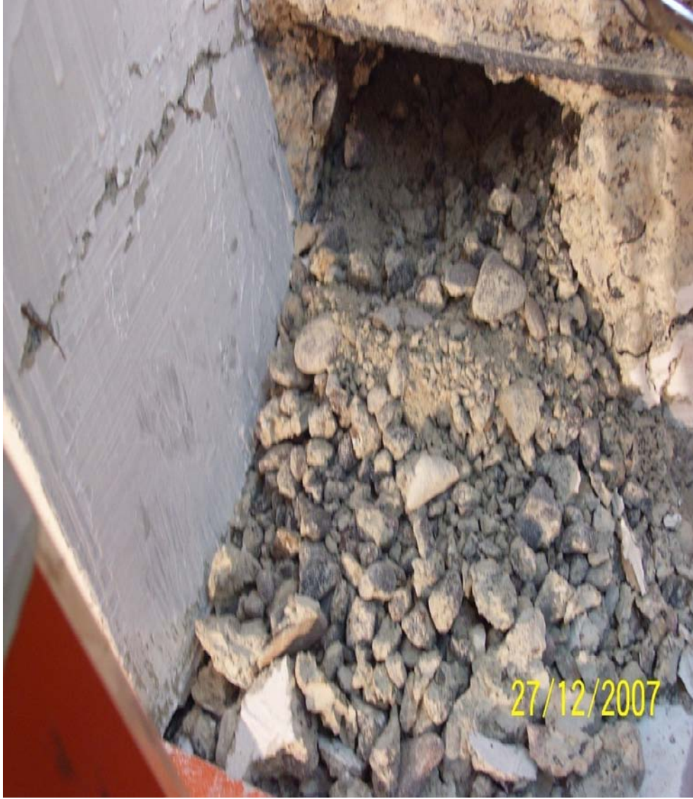
Resim 4.16. WJ1 elemanında düğüm bölgesi hasarı ve dökülen düğüm bölgesi betonu
