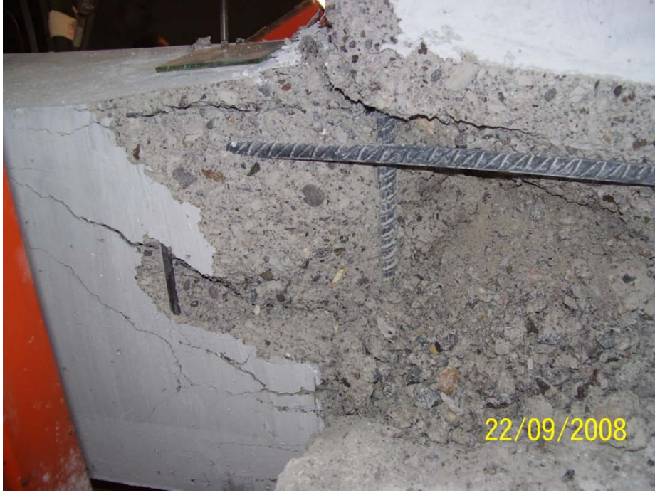
Resim 4.18. WJ2 elemanında düğüm bölgesinin durumu
