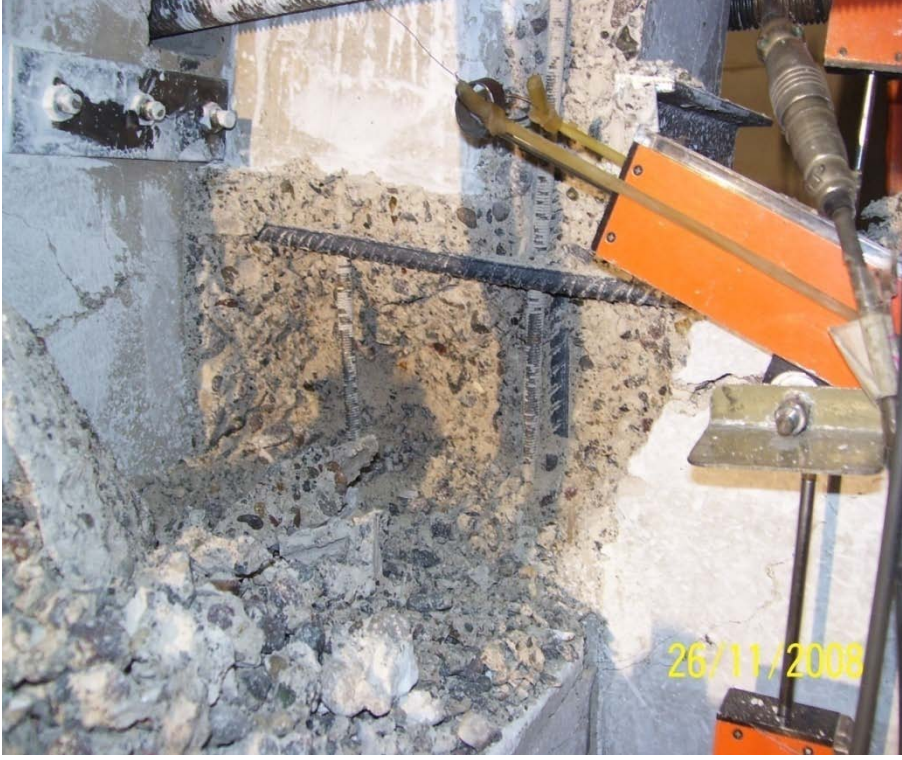
Resim 4.27. B2 elemanında düğüm bölgesinde oluşan hasar
