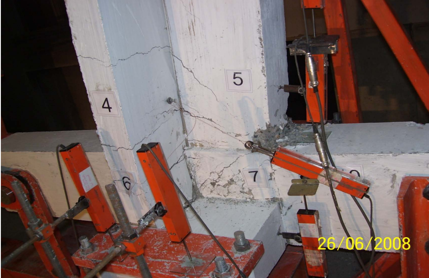
Resim 4.2 RC1-R2 elemanında kiriş ve düğüm bölgesi hasarı
