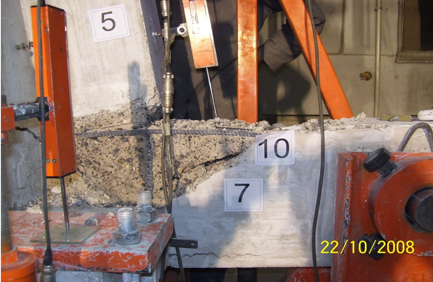
Resim 4.12. WC1d elemanında düğüm ve kolonda oluşan hasar
