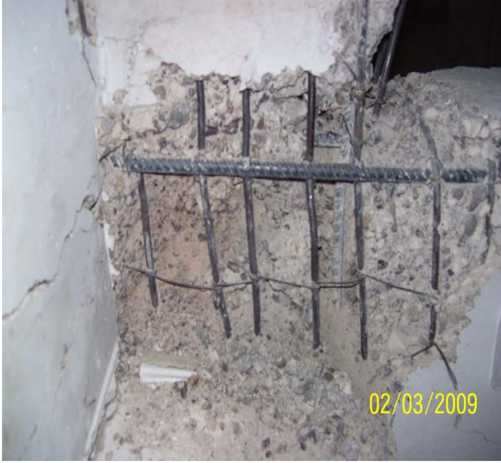
Resim 4.35. D2 elemanında düğüm bölgesi hasarı
