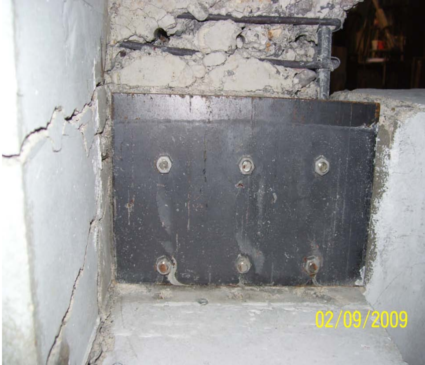
Resim 3.42. G2 güçlendirmesinde kabuk betonu kaldırıldıktan sonra düğüm bölgesi ön yüz görünüşü
