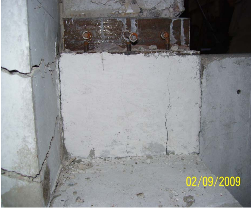
Resim 3.43. G2 elemanında deneyden sonra düğüm bölgesi kabuk betonunun görünüşü
