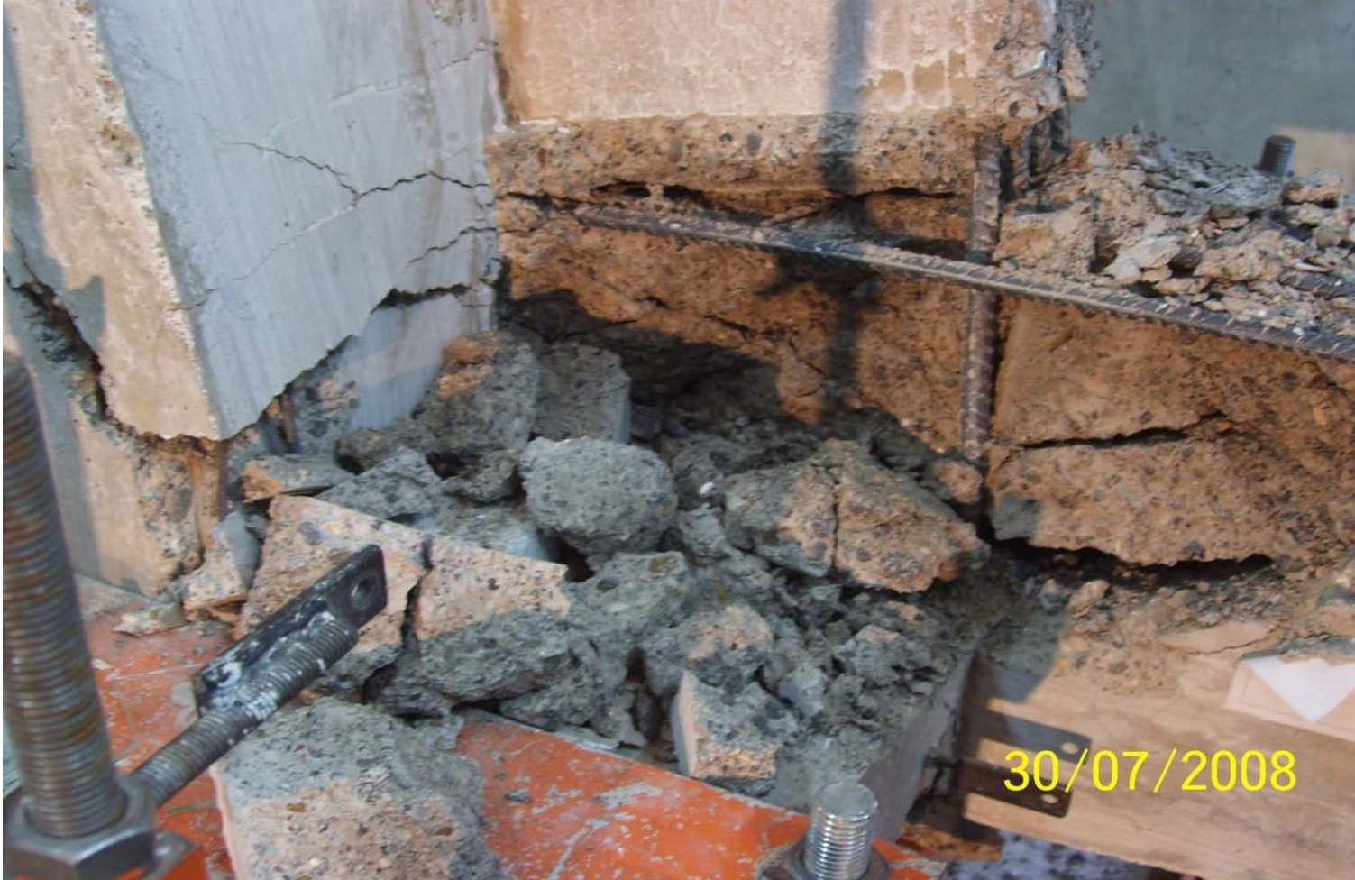
Resim 4.10. WC1c elemanında düğüm bölgesi hasarı
