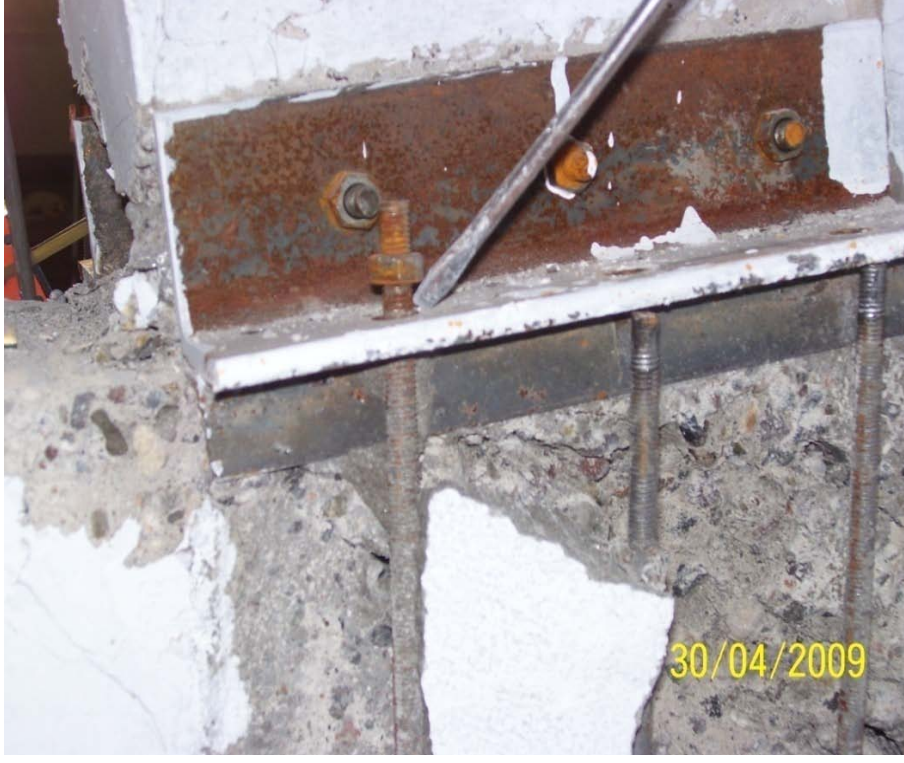
Resim 3.31. E1 elemanının bulonlarındaki sıyrılmalar ve birleşim hasarı
