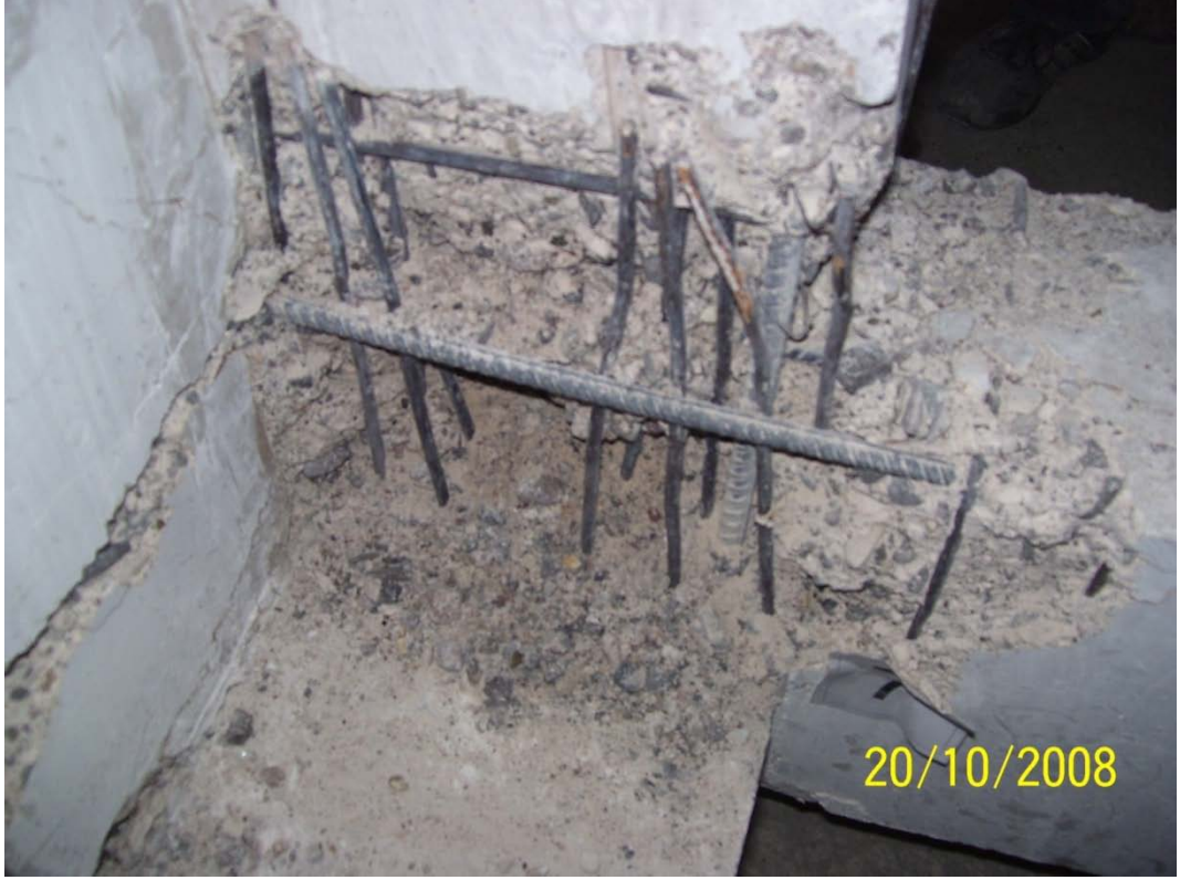
Resim 4.33. D1 Elemanında düğüm bölgesinden çıkan U etriye kolları
