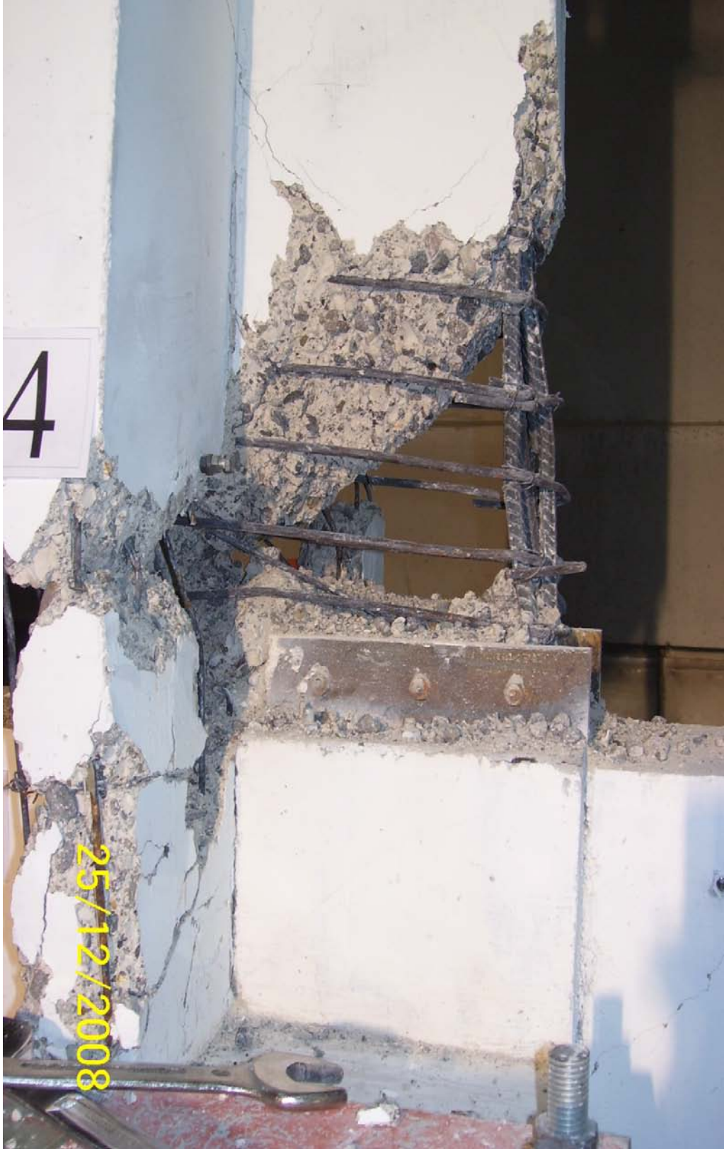
Resim 4.39. E2 elemanında kirişte oluşan hasar
