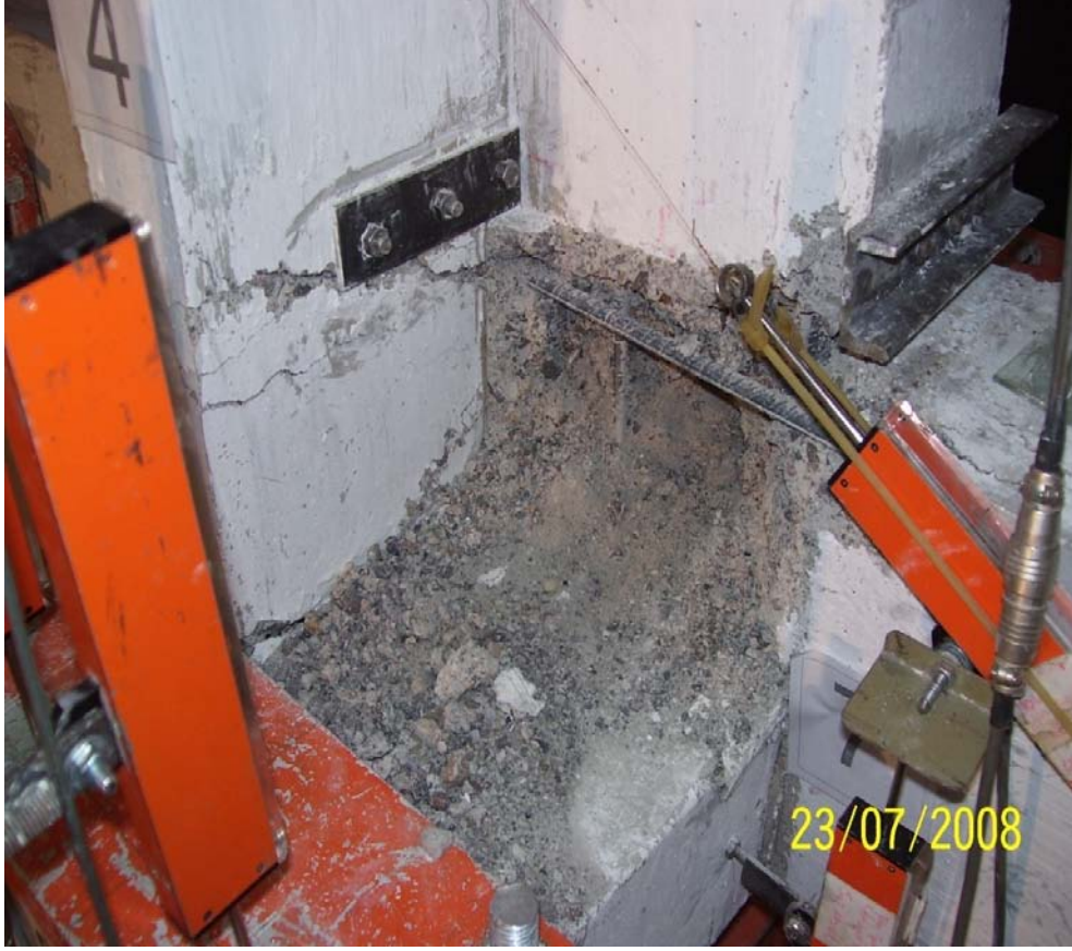
Resim 4.25. B1 elemanında düğüm bölgesinde oluşan hasar
