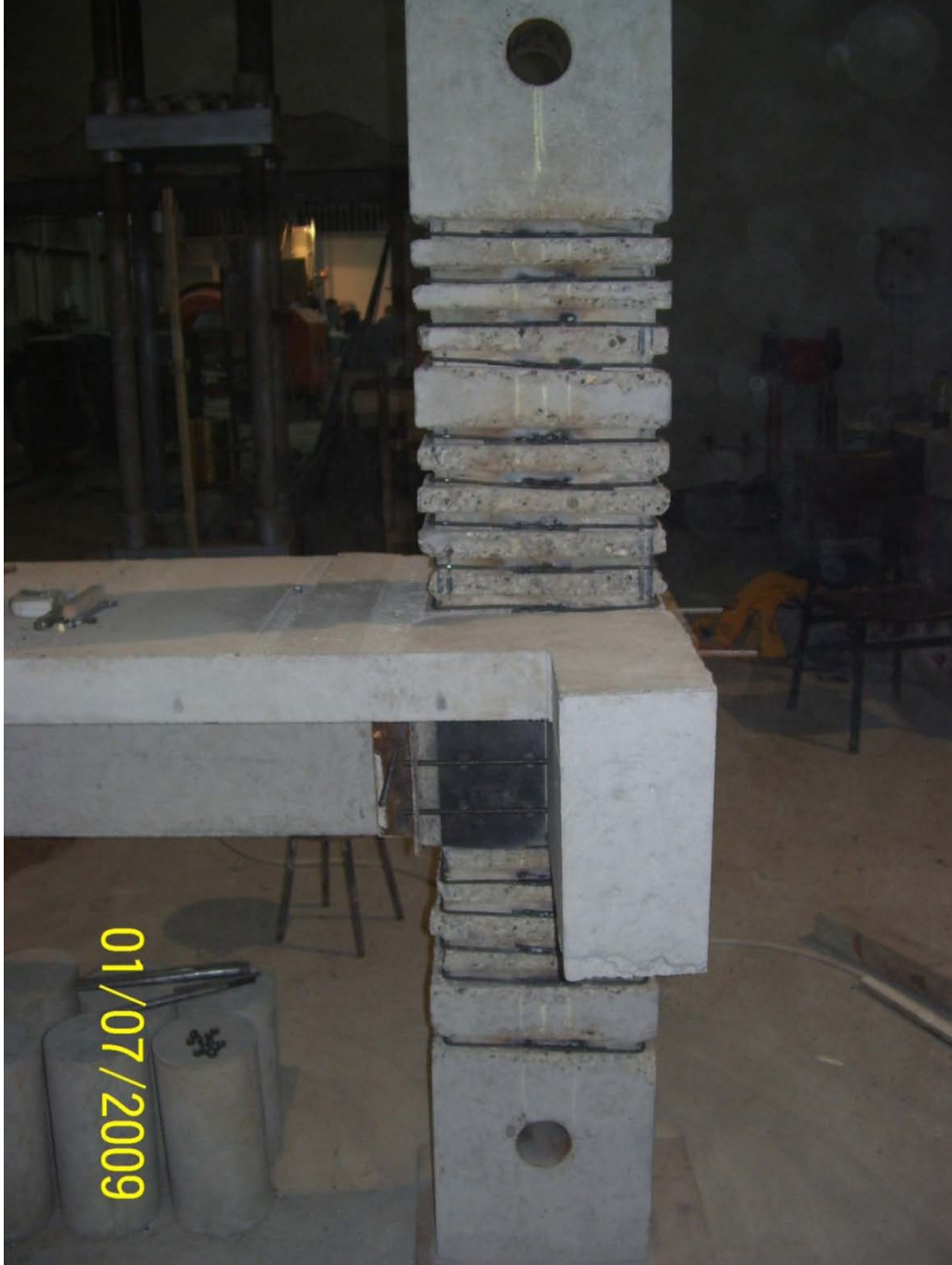
Resim 4.42. G2 elemanının kolonunun kesmeye karşı güçlendirilmesi
