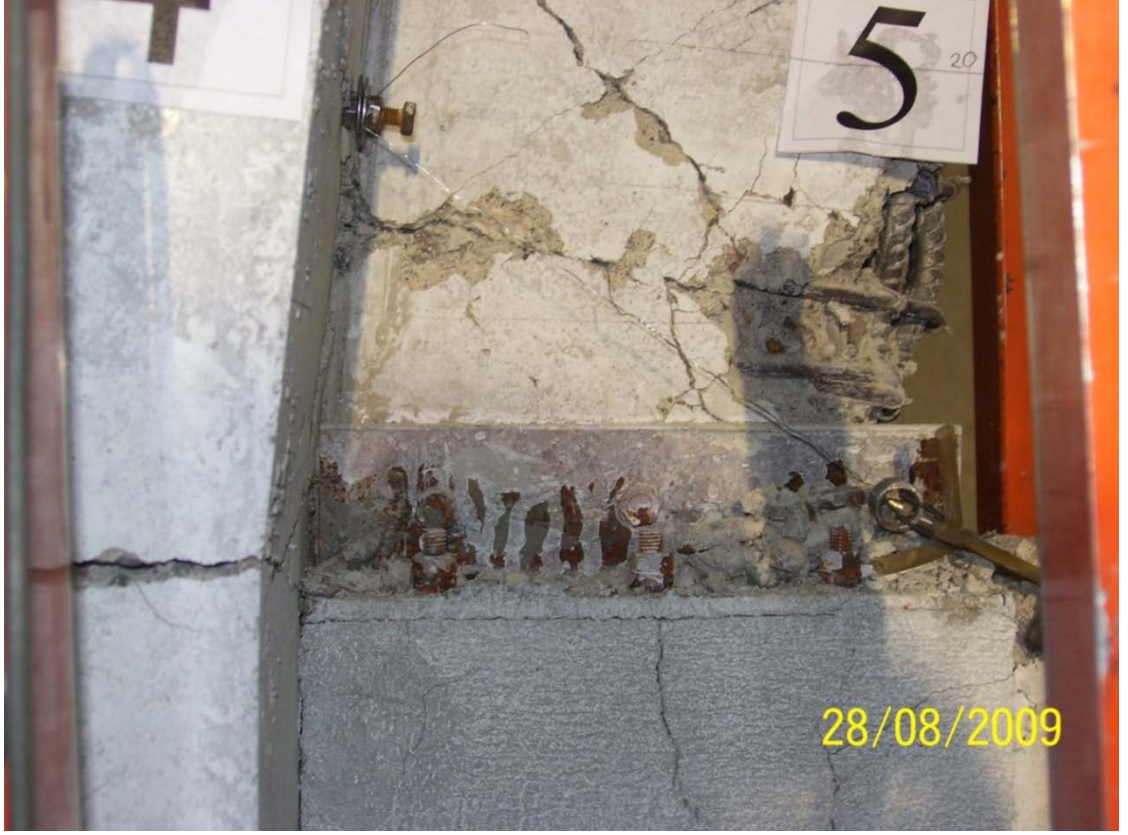
Resim 4.29. C1 elemanında kirişte oluşan hasar
