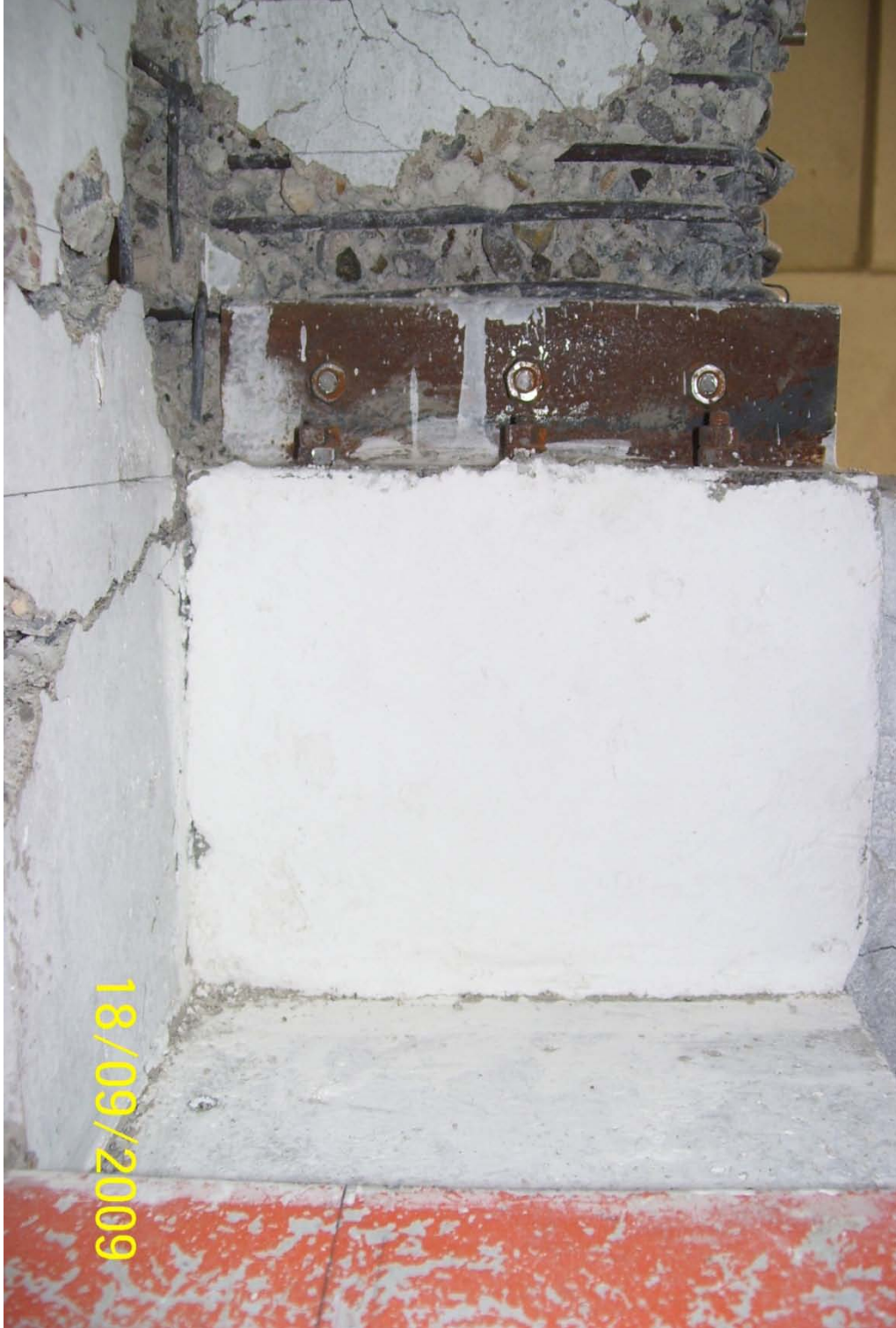
Resim 4.44. G2 elemanında deneyden sonra düğüm bölgesinin görünüşü ve kirişte oluşan hasar
