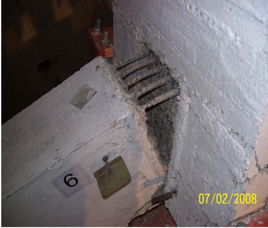
Resim 3.11. WC1a elemanında üst kolonun döşemeden ayrılması
