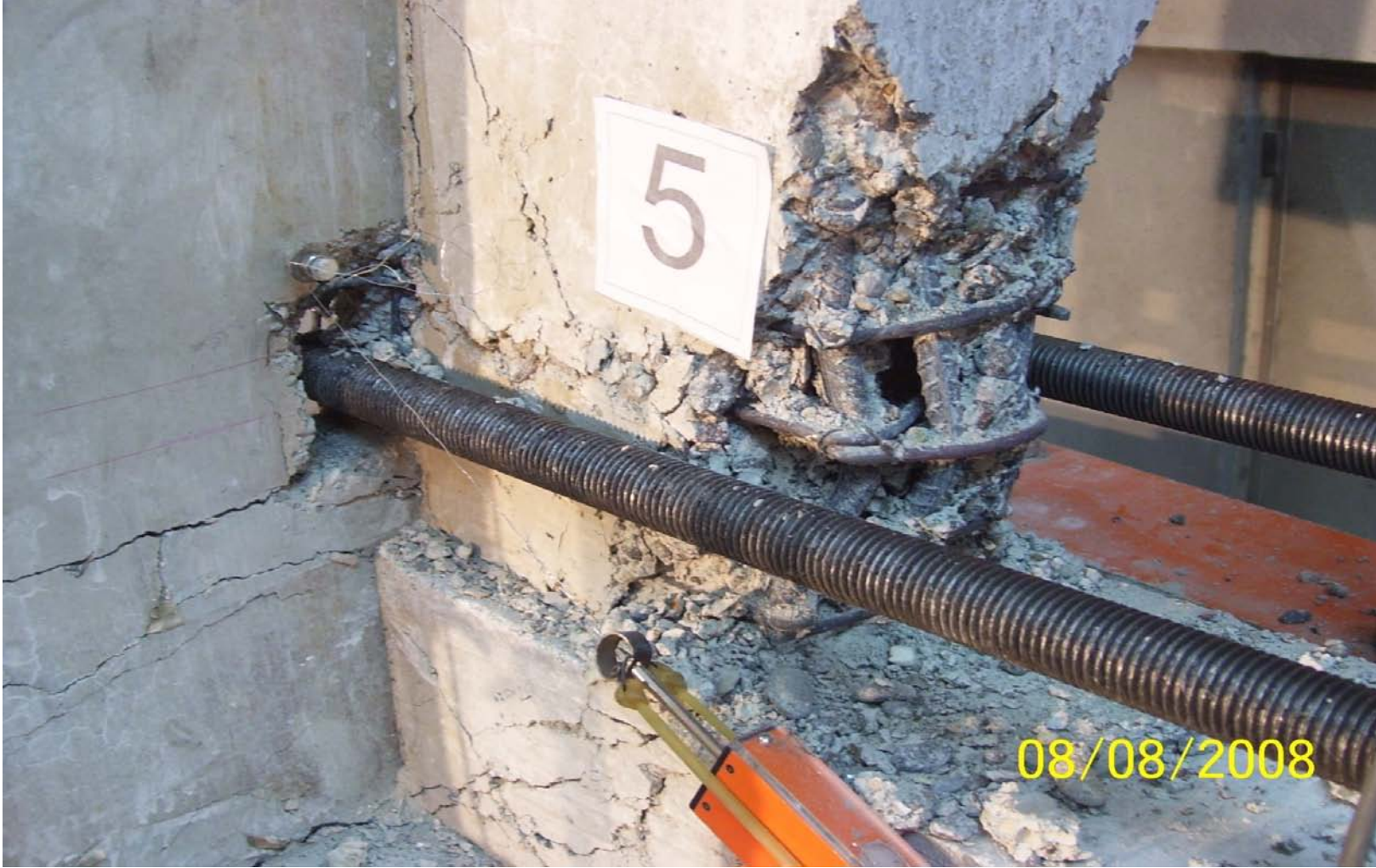
Resim 4.4. RC2 elemanında kiriş hasarı ve kirişte oluşan plastik mafsall
