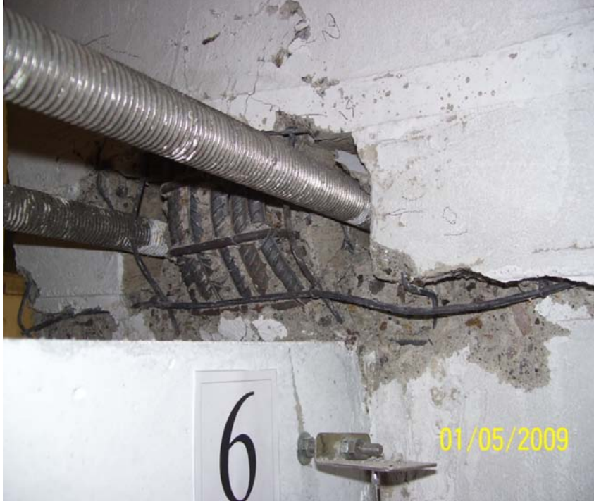
Resim 3.33. C2 Elemanında Kiriş Ve Döşeme Üst Donatılarının Burkulması
