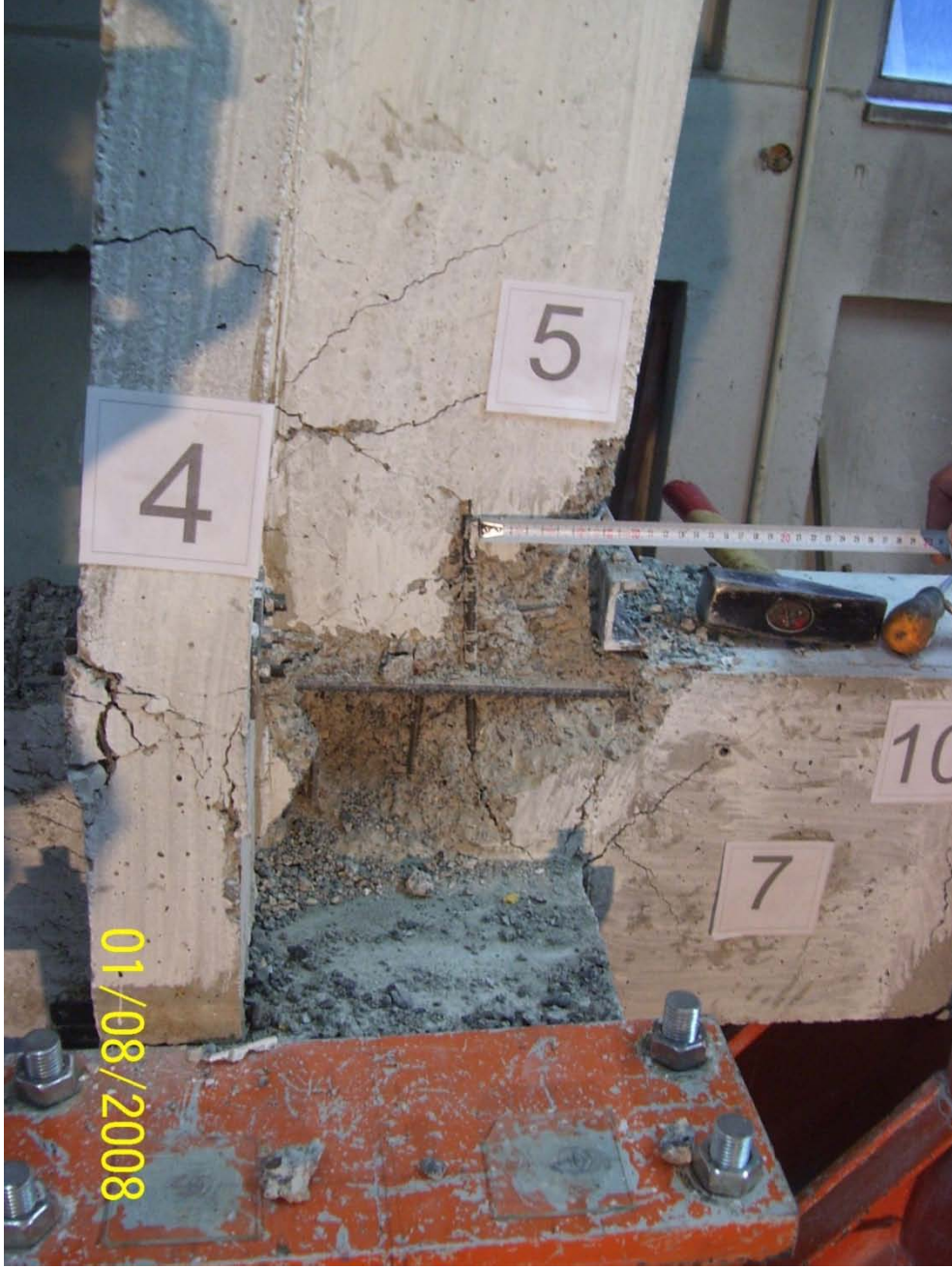
Resim 4.20. A1elemanında oluřan düğüm bölgesi hasarı
