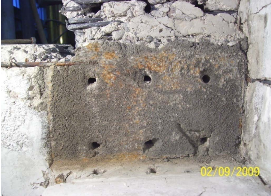
Resim 3.40. F1 güçlendirmesinde kabuk betonu ve çelik plaka kaldırıldıktan sonra düğüm bölgesi arka yüz görünüşü
