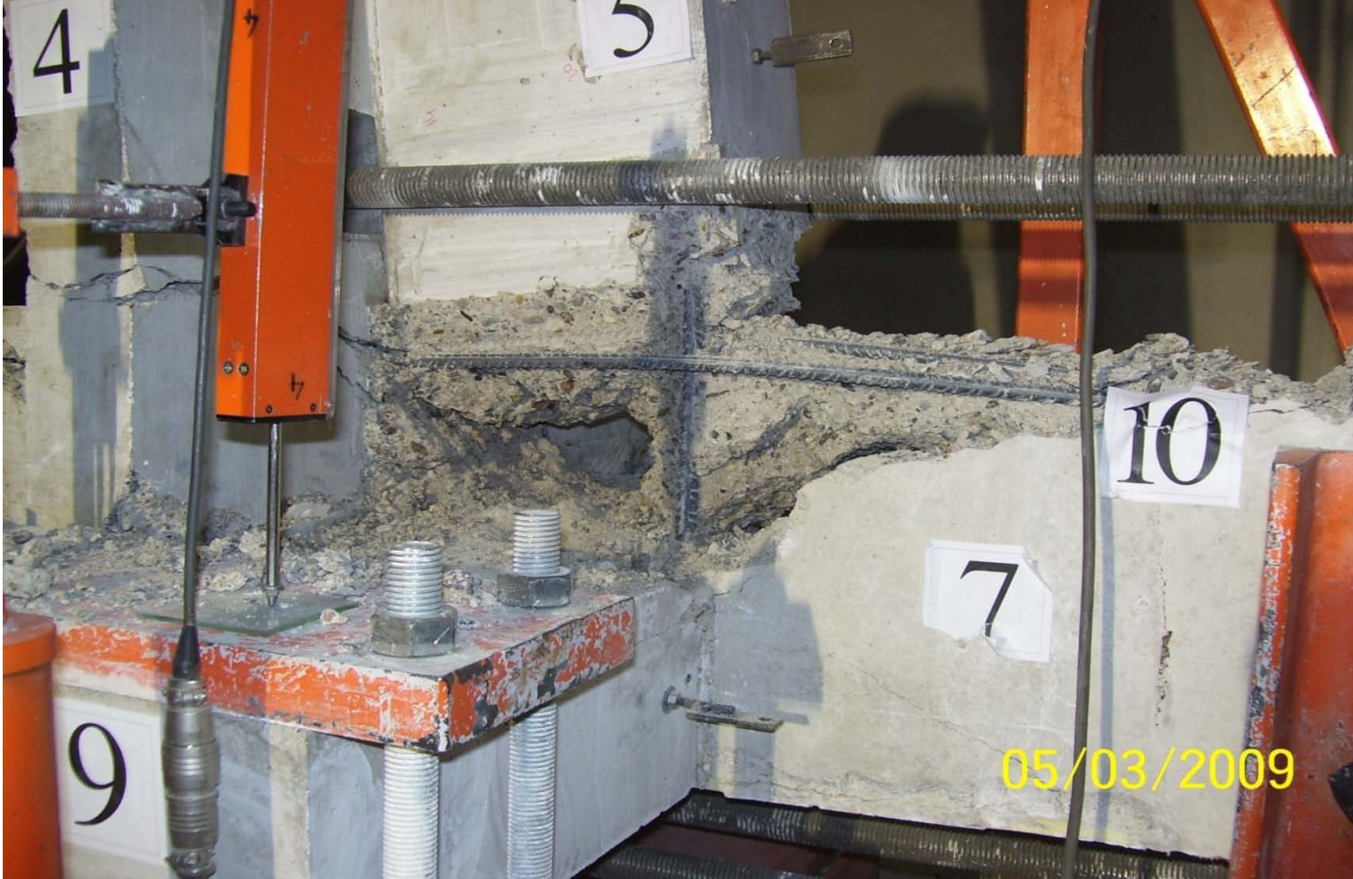
Resim 4.14. WC2d elemanında düğüm ve alt kolon hasarı
