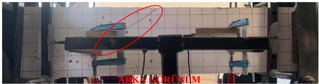
Şekil 4.20. BK-N-0-B numunesi ilk çatlak ve maksimum burulma momenti değerlerinde ön ve arka yüzey için hasar durumu
