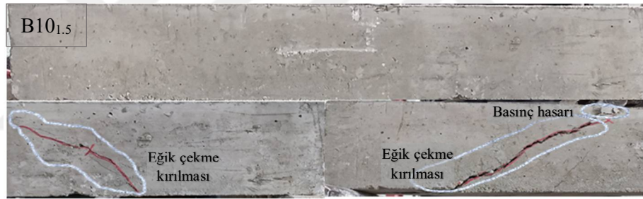
Şekil 4.24. B10_{1.5} kiriş numunesine ait göçme sonrası hasar detayları
