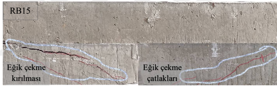
Şekil 4.9. RB15 referans kiriş numunesine ait göçme sonrası hasar detayları
