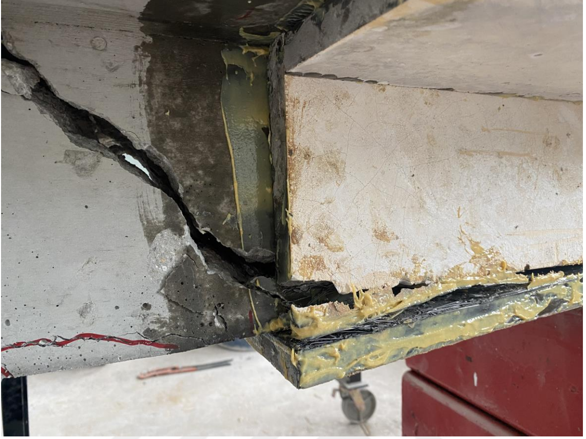
Şekil 5.24 B6 numunesinin yükleme sonrası oluşan çatlaklar
