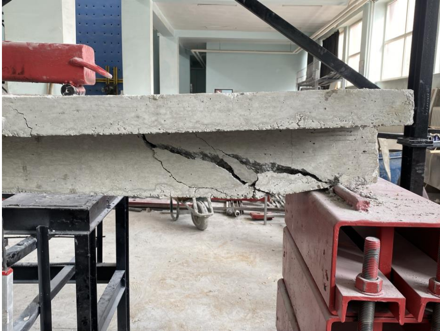
Şekil 5.4 B1 referans numunesinin yükleme sonrası oluşan çatlaklar
