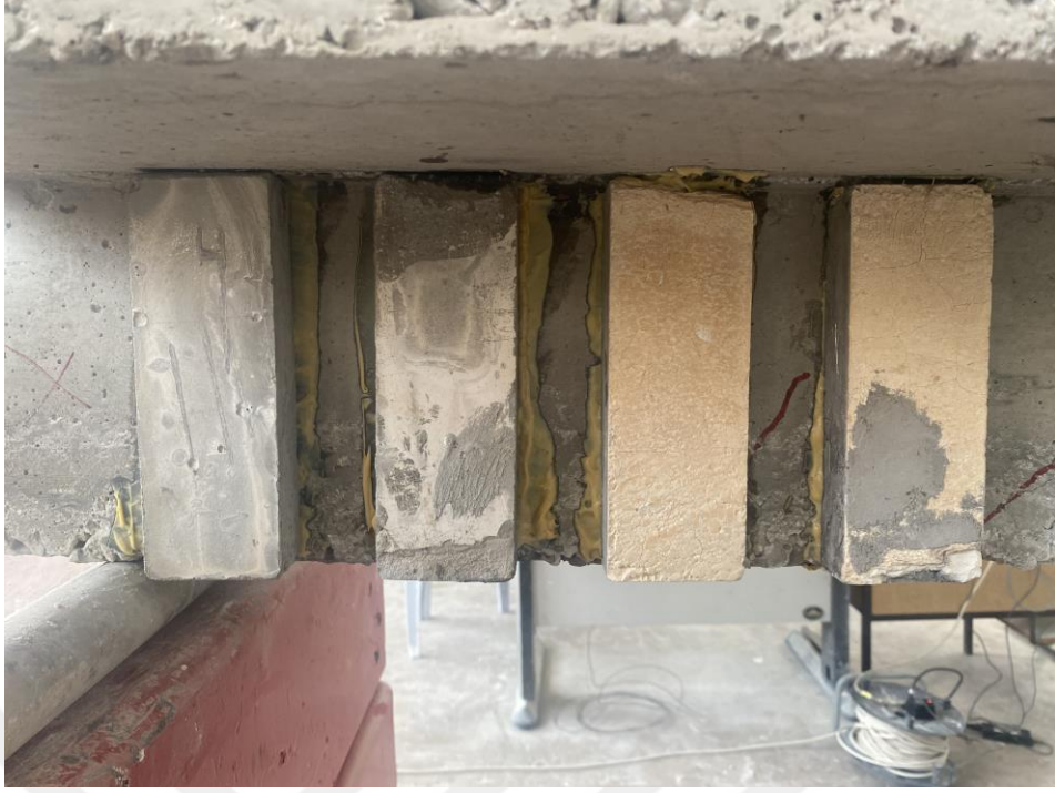
Şekil 5.8 B2 numunesinin yükleme sonrası oluşan çatlaklar
