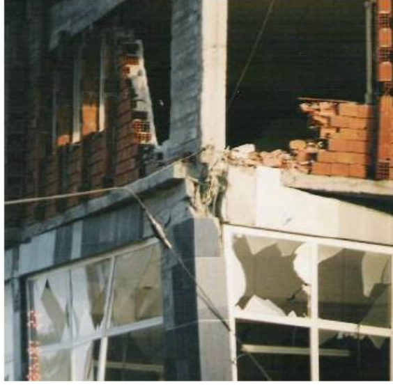
Şekil 2.26. Birleşim bölgelerinde hasar oluşumu
