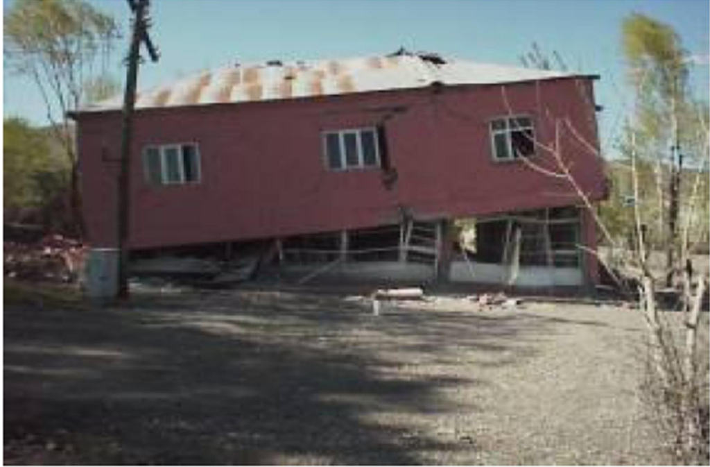
Şekil 2.28. Yumuşak katlı yapı hasarı
