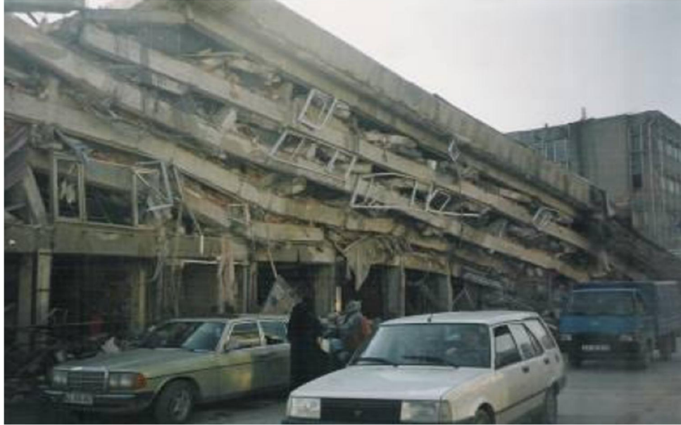
Şekil 2.13. Kuvvetli kiriş-Zayıf kolon hasarı
