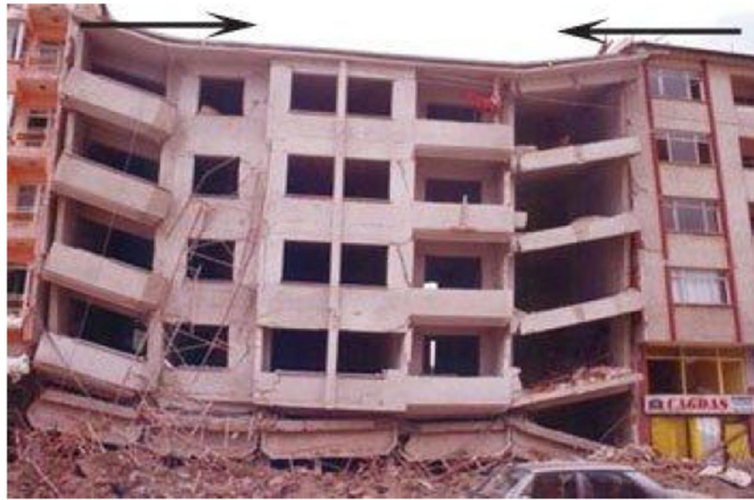
Şekil 2.30. Çekiçleme etkisinde yıkılmış bir bina
