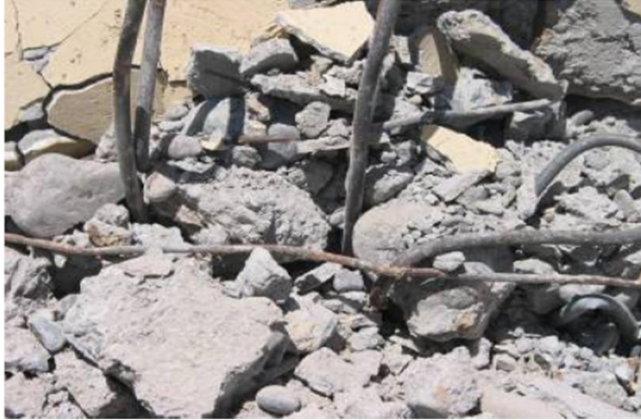
Şekil 2.25. Uygun olmayan beton kalitesi sonucu hasarlar
