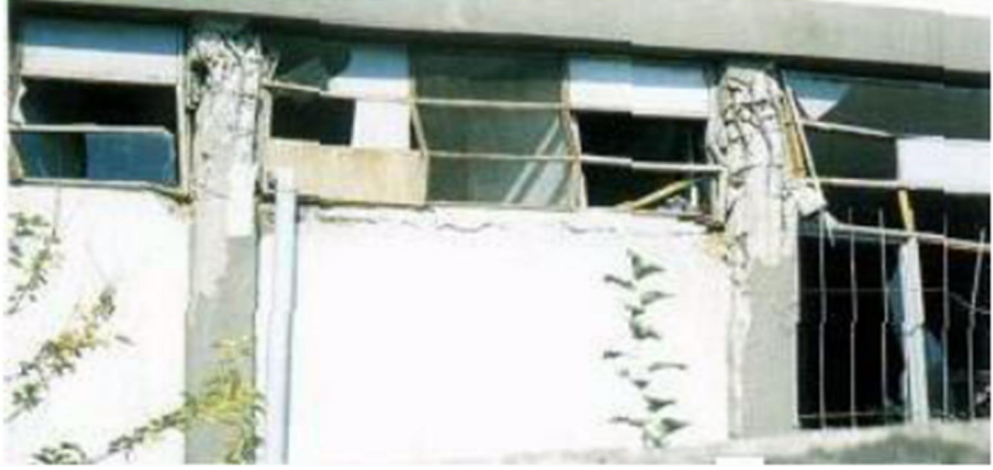
Şekil 2.29. Bant pencere nedeniyle kısa kolon hasarı
