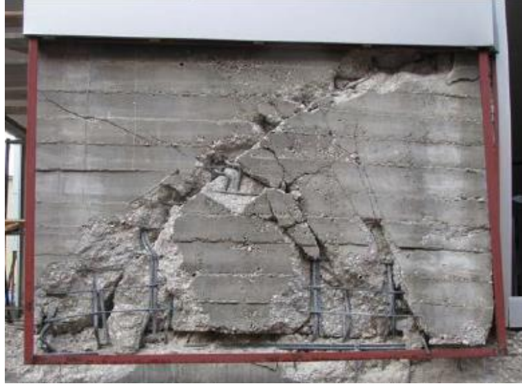
Şekil 4.19. Kesme çatlakları oluşmuş bir perde duvar (Yılmaz ve Umu)
