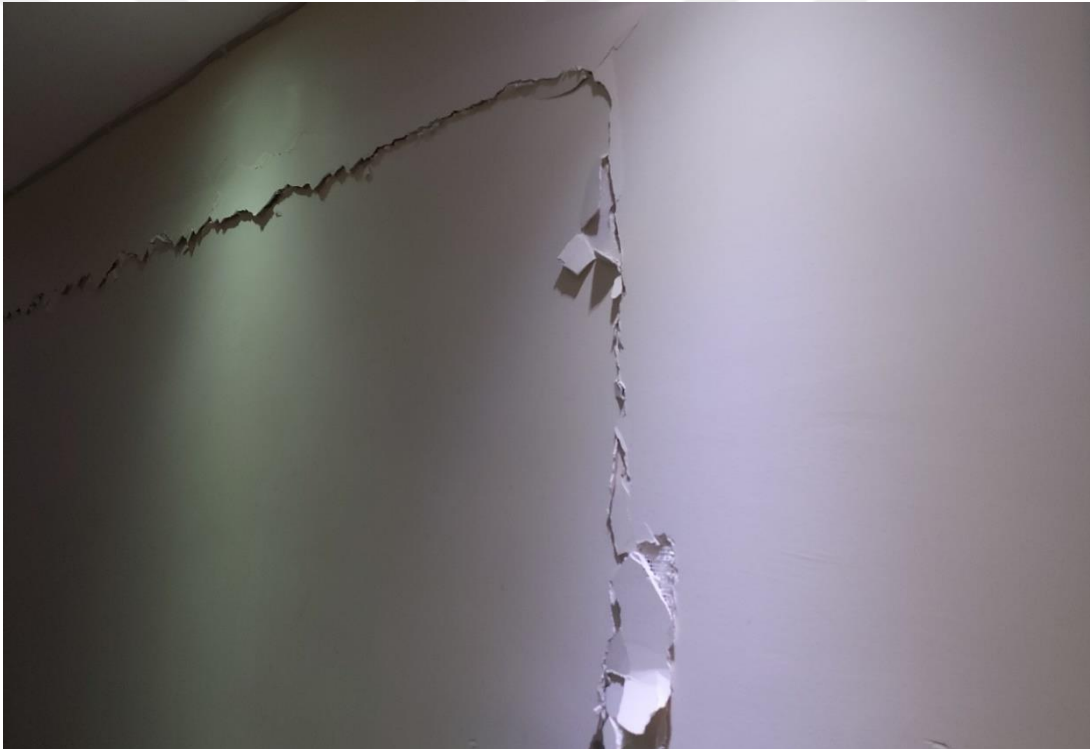
Şekil 4.26. İzmir (Seferihisar) depremi sırasında betonarme yapıda görülen sıva çatlağı
