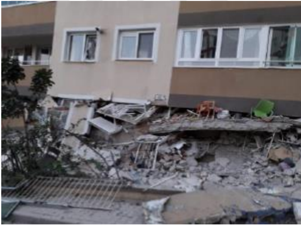
Şekil 5.47. Yumuşak kat düzensizliği nedeniyle çökmüş bir bina (AFAD, 2021)
