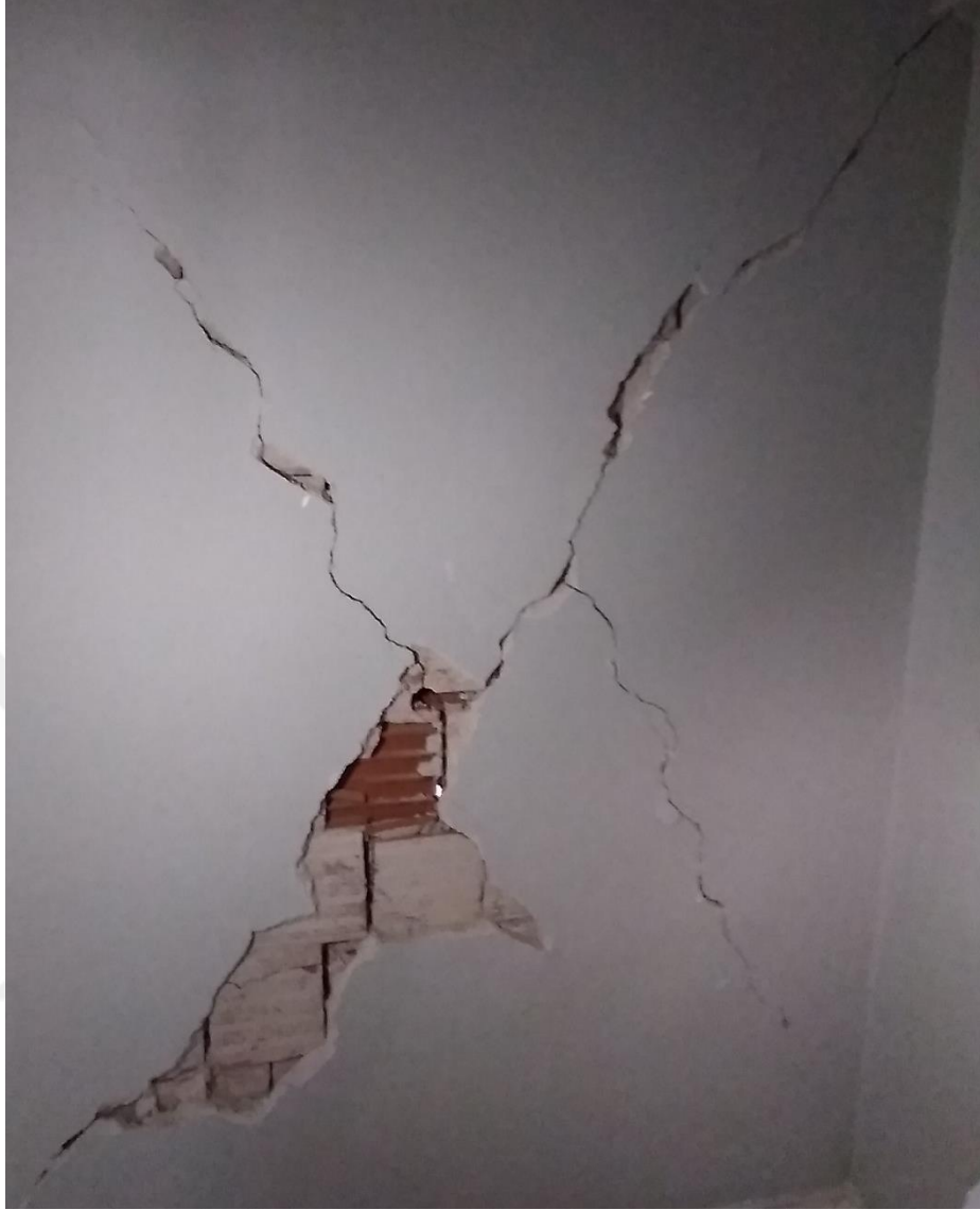
Şekil 5.32. Dolgu duvarlarda oluşan hasarlar
