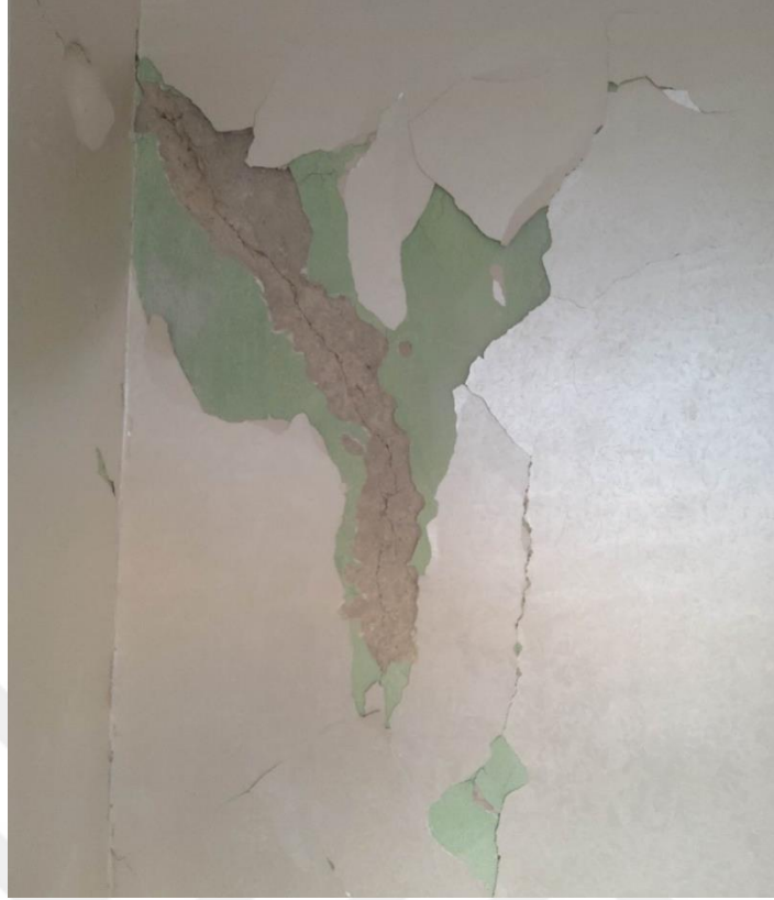
Şekil 5.30. Perde duvarlarda görülen hasarlar
