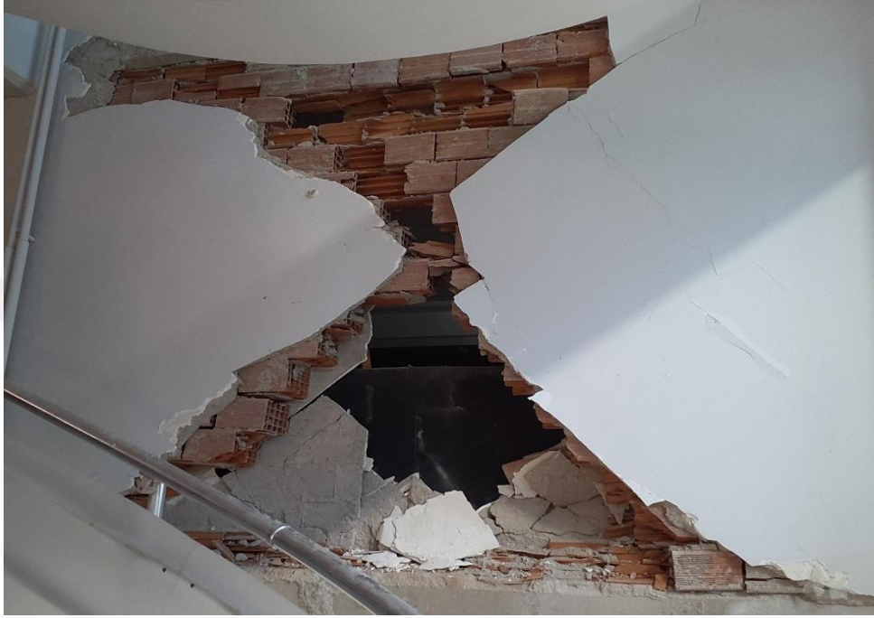
Şekil 4.34. Deprem titreşimleri dolayısıyla duvarlarda oluşan kırılmalar
