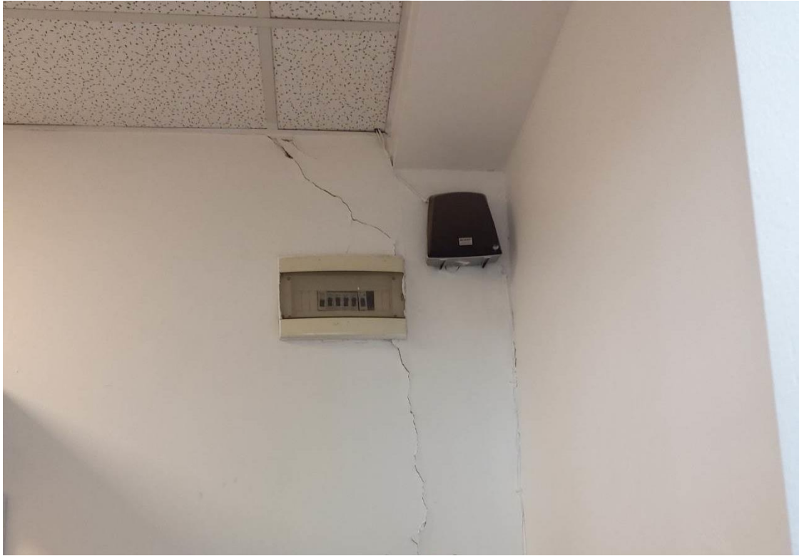
Şekil 4.28. Tesisattan kaynaklanan duvar çatlakları
