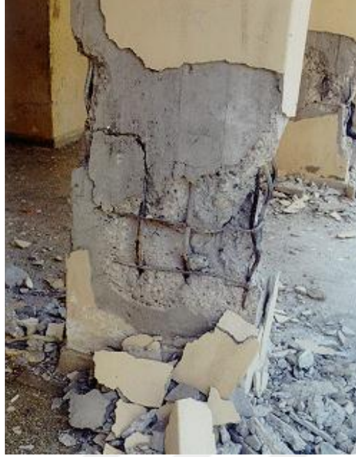
Şekil 4.12. Kesme ve eğilme etkileri altında hasar almış kolon (Çırak, 2011)
