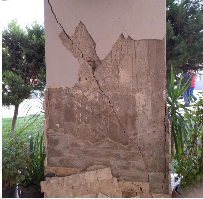
Şekil 5.54. Hasar alan perde duvarlar
