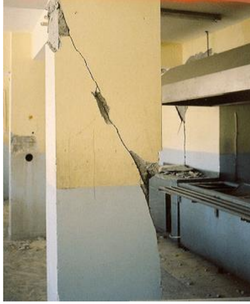
Şekil 4.10. Kesme çatlağı oluşmuş bir kolon
