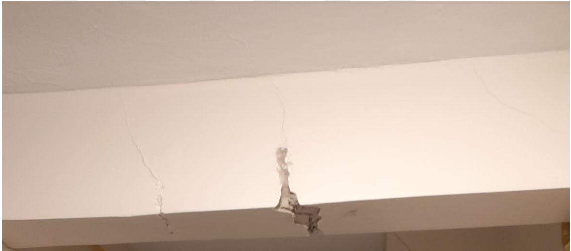
Şekil 4.21. Eğilme çatlakları meydana gelmiş bir kiriş
