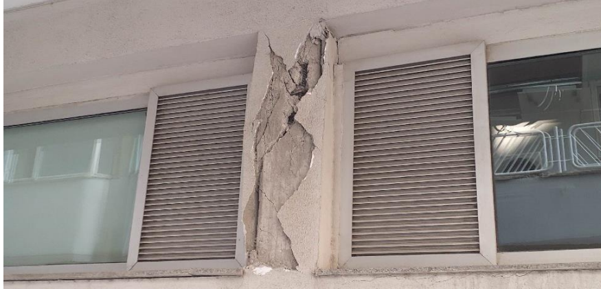
Şekil 5.49. Kısa kolon oluşumu nedeniyle hasar alan bir yapısal eleman
