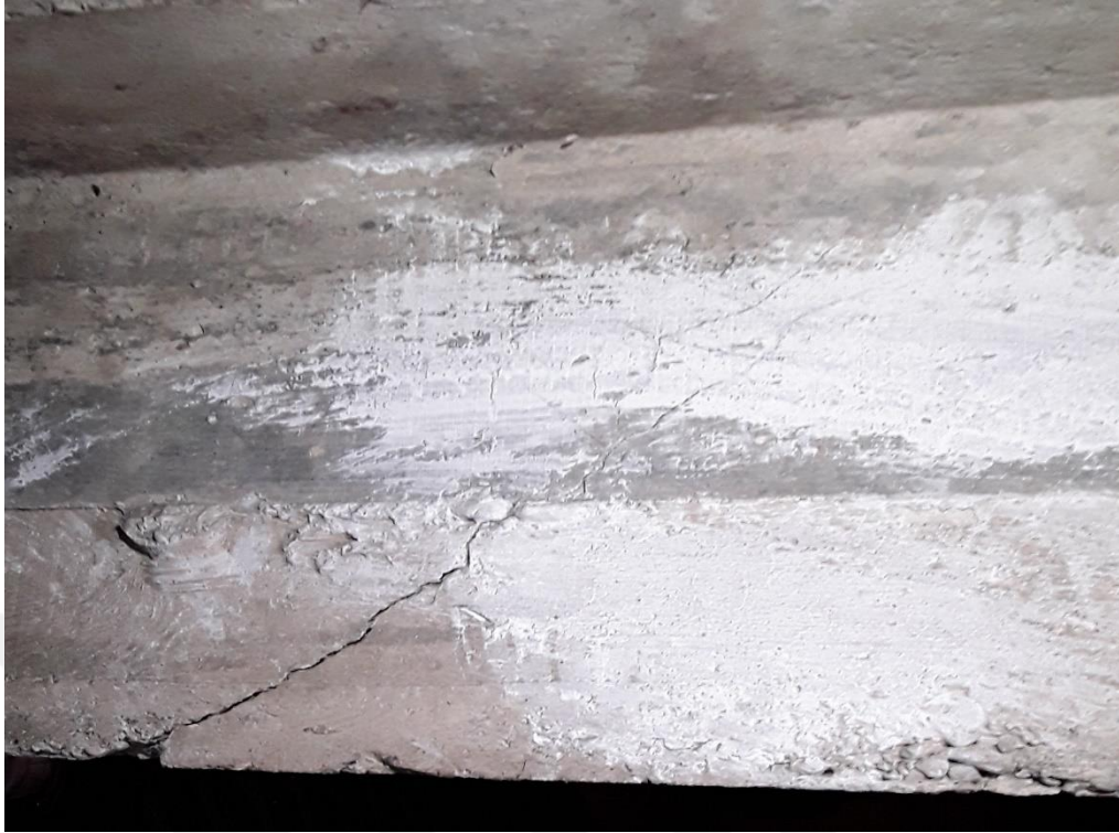
Şekil 5.29. Kirişlerde oluşan hasarlar
