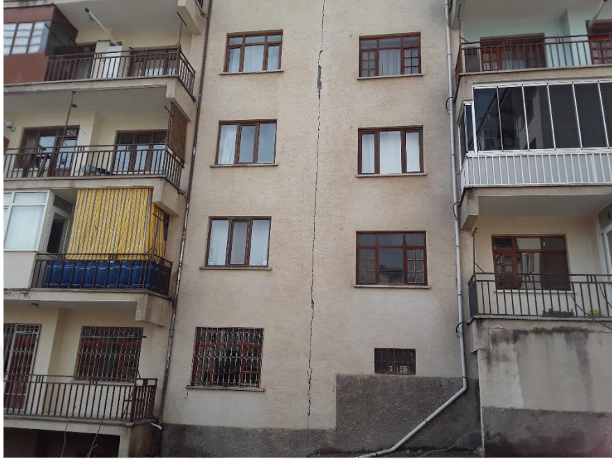
Şekil 5.24. Yeterli derz bırakılmamış bir yapıda görülen hasar
