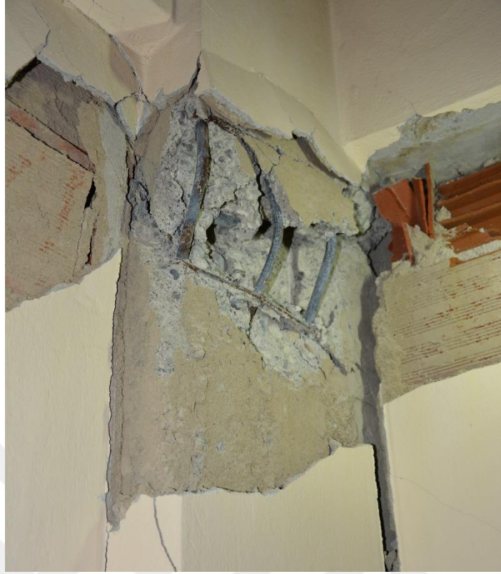
Şekil 5.28. Kolonlarda görülen hasarlar
