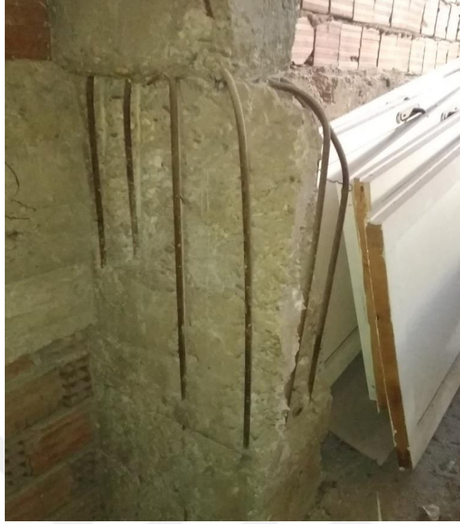
Şekil 5.25. Uygun olmayan etriye aralığından ve nervürsüz donatı kullanımından dolayı oluşan kolon hasarı
