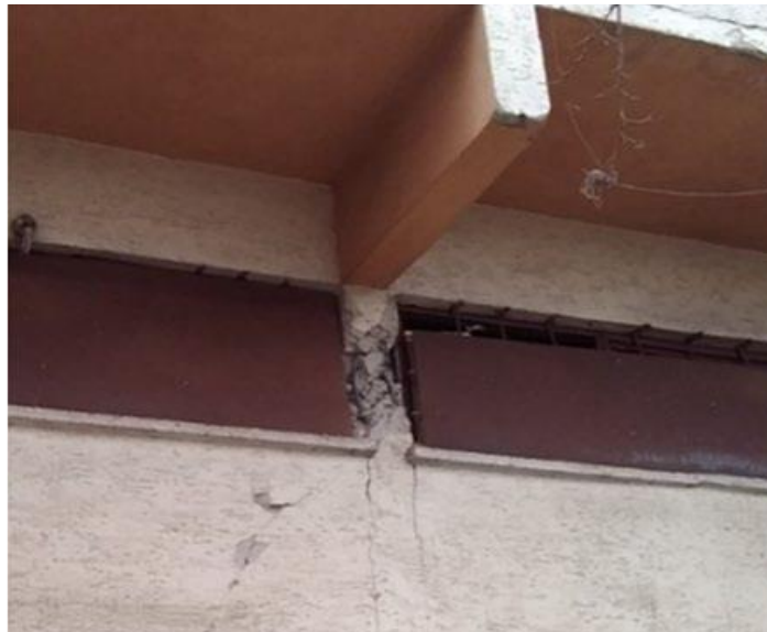
Şekil 5.26. Kısa kolon hasarı (Sayın ve ark, 2019)
