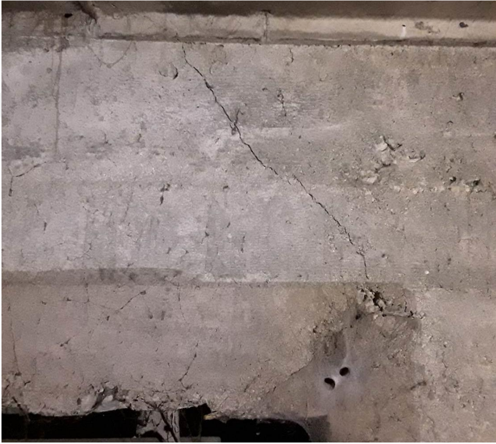
Şekil 4.23. Kesme çatlakları oluşmuş bir kiriş
