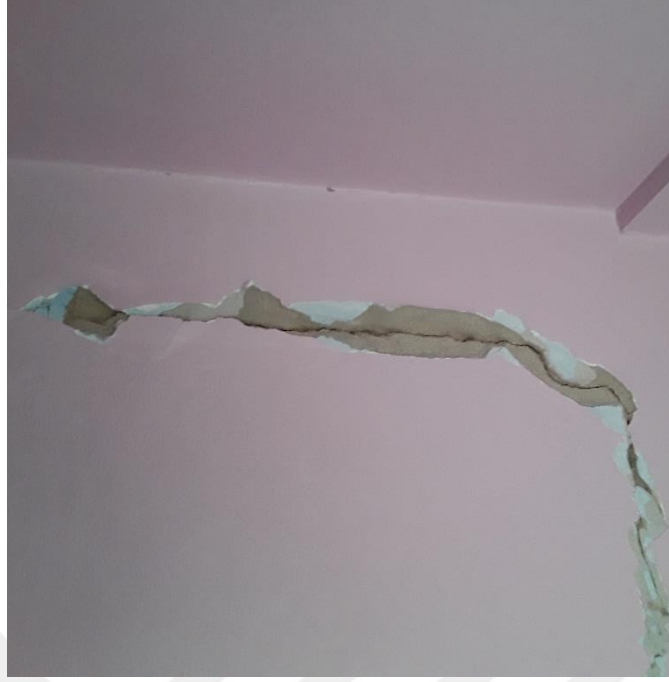
Şekil 4.30. Deprem sırasında oluşan hafif dolgu duvar hasarı
