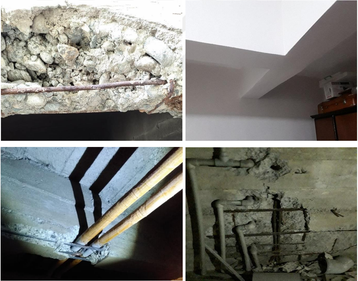
Şekil 5.27. Malzeme, işçilik ve kullanım kusurları
