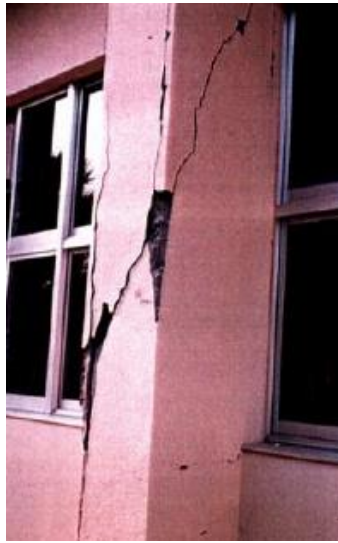
Şekil 4.16. Burulma hasarı oluşmuş bir yapı (Yılmaz ve Umu)
