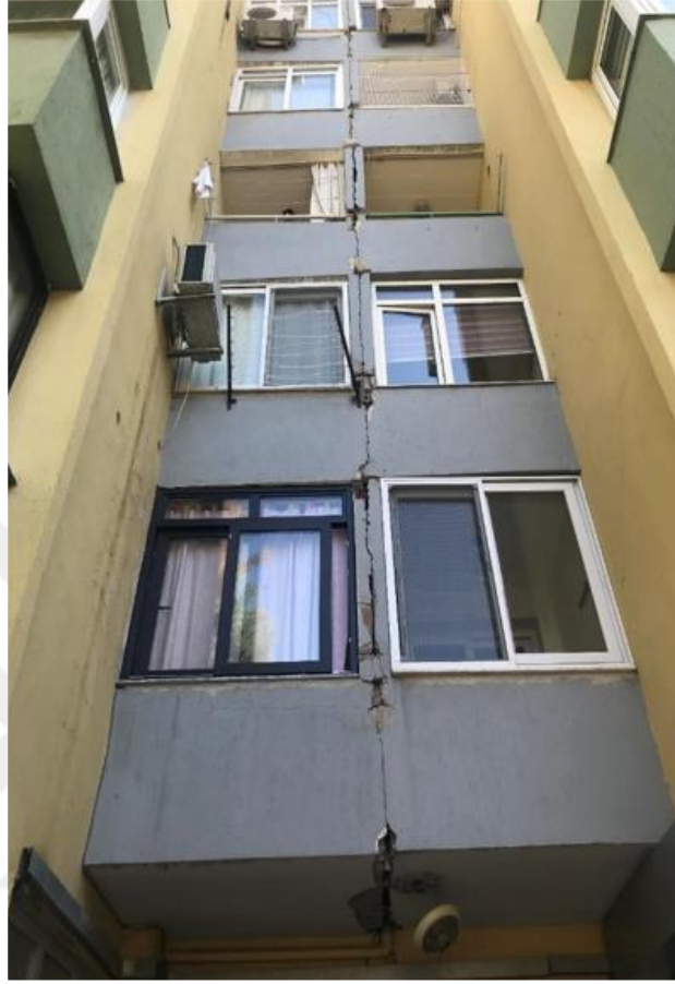
řekil 5.50. Derz bořluđu bırakılmaması nedeniyle hasar alan bir yapı
