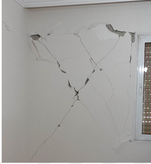
Şekil 4.32. Deprem sırasında oluşan orta dereceli dolgu duvar hasarı
