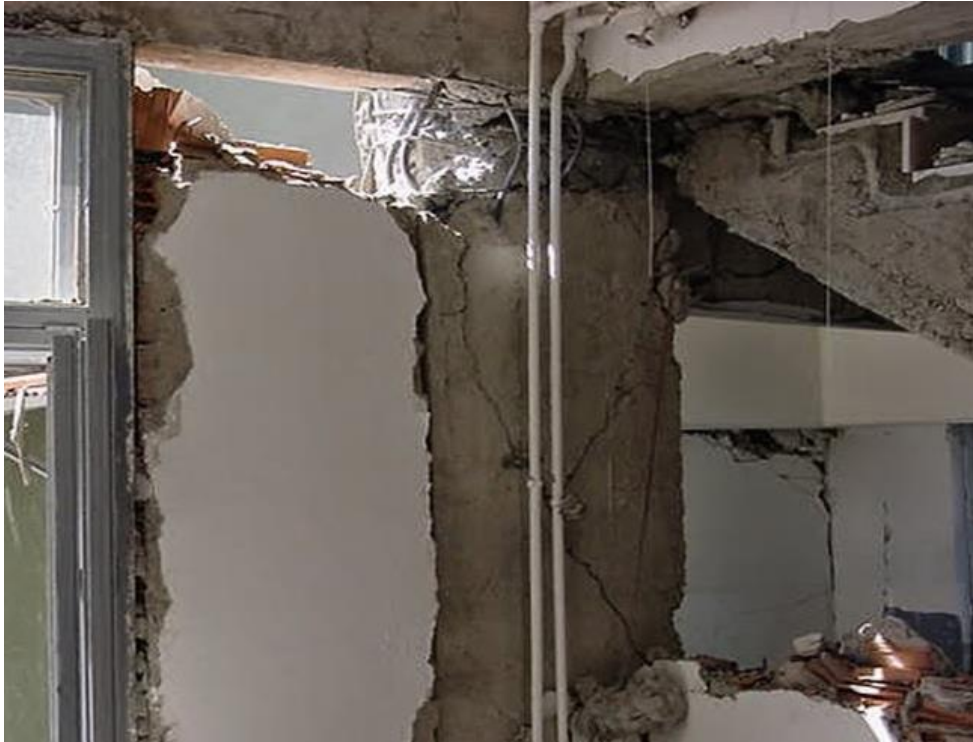
Şekil 4.14. Basınç kırılması meydana gelmiş bir kolon (Yılmaz ve Umu)
