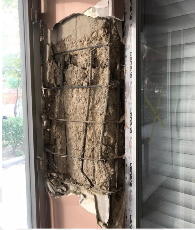
Şekil 5.51. Uygun etriye kullanılmaması dolayısıyla hasar almış bir kolon
