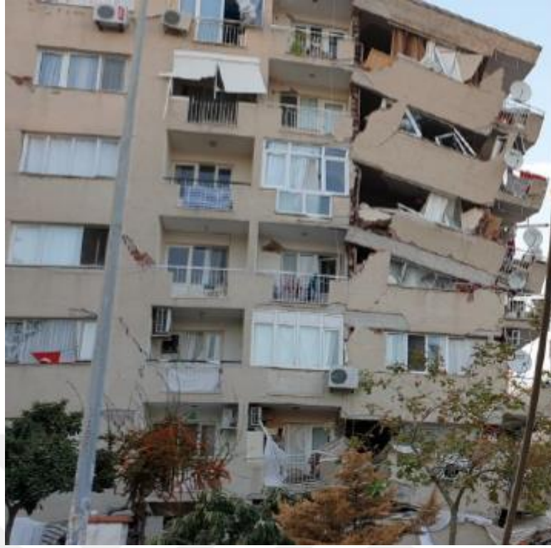
Şekil 5.48. Ağır çökmelerinin bulunması nedeniyle kısmi göçme yaşanmış bir bina (AFAD, 2021)
