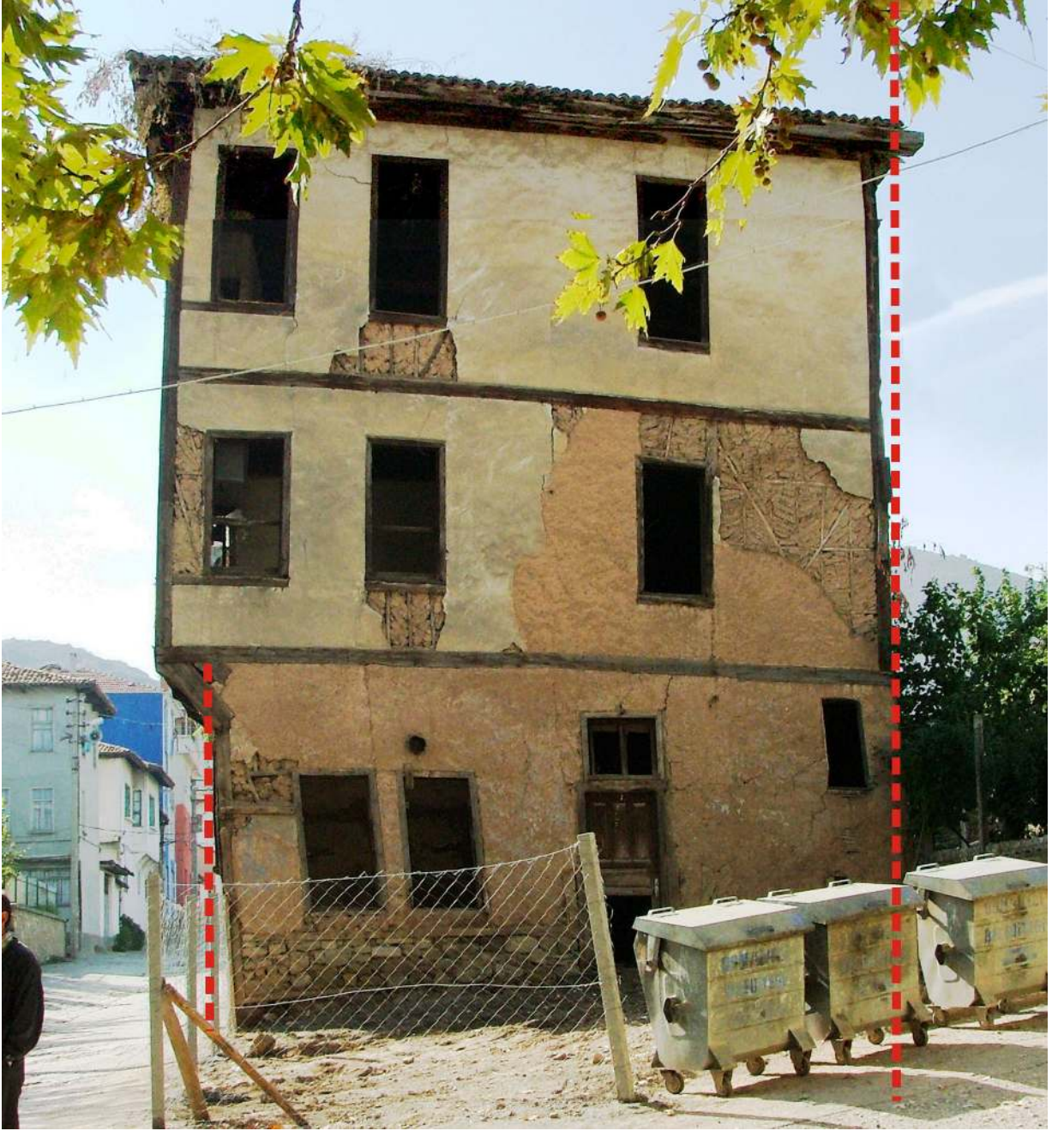
Resim 3.10 Yapıda dönme momenti etkisiyle oluşan düşeyden kaçma
