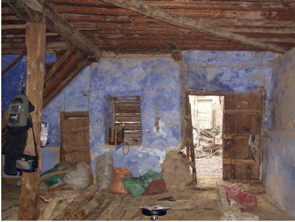
Resim 3.15 Tavan kaplaması yapılmamış mekanlar (zemin kat).
