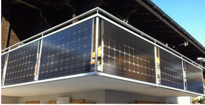
Şekil 56. Balkonlarda FV sistemlerin entegre edilmiş görünümü (URL-21, 2017).
