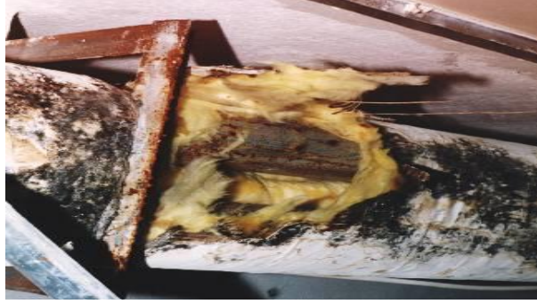
Şekil 5.15. Yoğuşma sebebiyle zarar görmüş bir tesisat (Böke, 2017).
