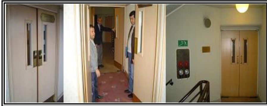
Resim 6.5. Yangın güvenlik holü kapıları
