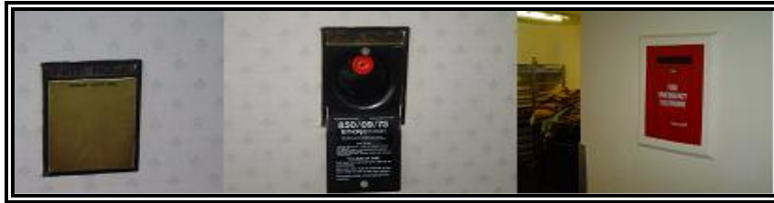
Resim 6.3. Yangın hortumu ve yangın imdat telefonu
