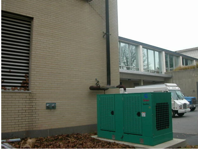
Resim 5.1. Kaçış yolu aydınlatmalarını besleyen jeneratör [81]
