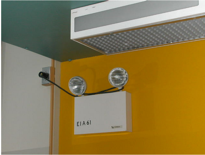
Resim 5.2. Jeneratörlerin beslediği acil aydınlatma elemanları [81]
