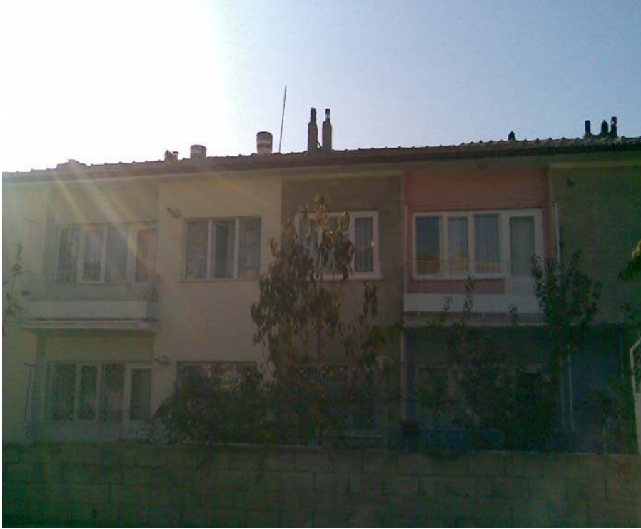
Şekil 2.18 Duvar boşluk oranı fazla olan yığma bina
