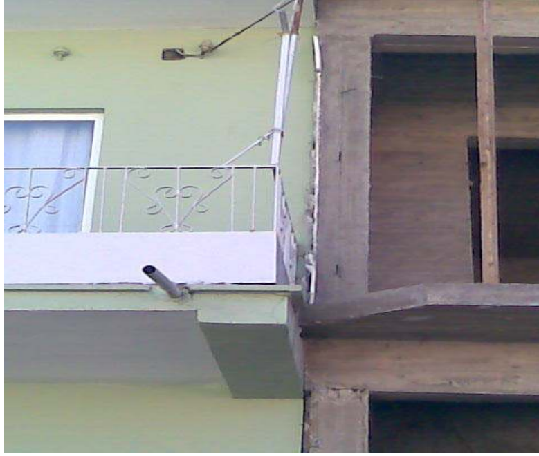
Şekil 2.22 Çarpışma etkisi olan yığma-betonarme bina
