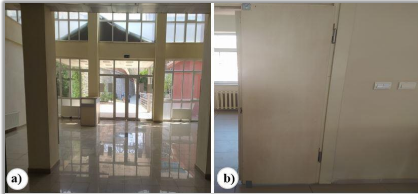
Şekil 17. Mühendislik fakültesi acil çıkış kapıları a) çıkış kapısı, b) sınıf kapısı
