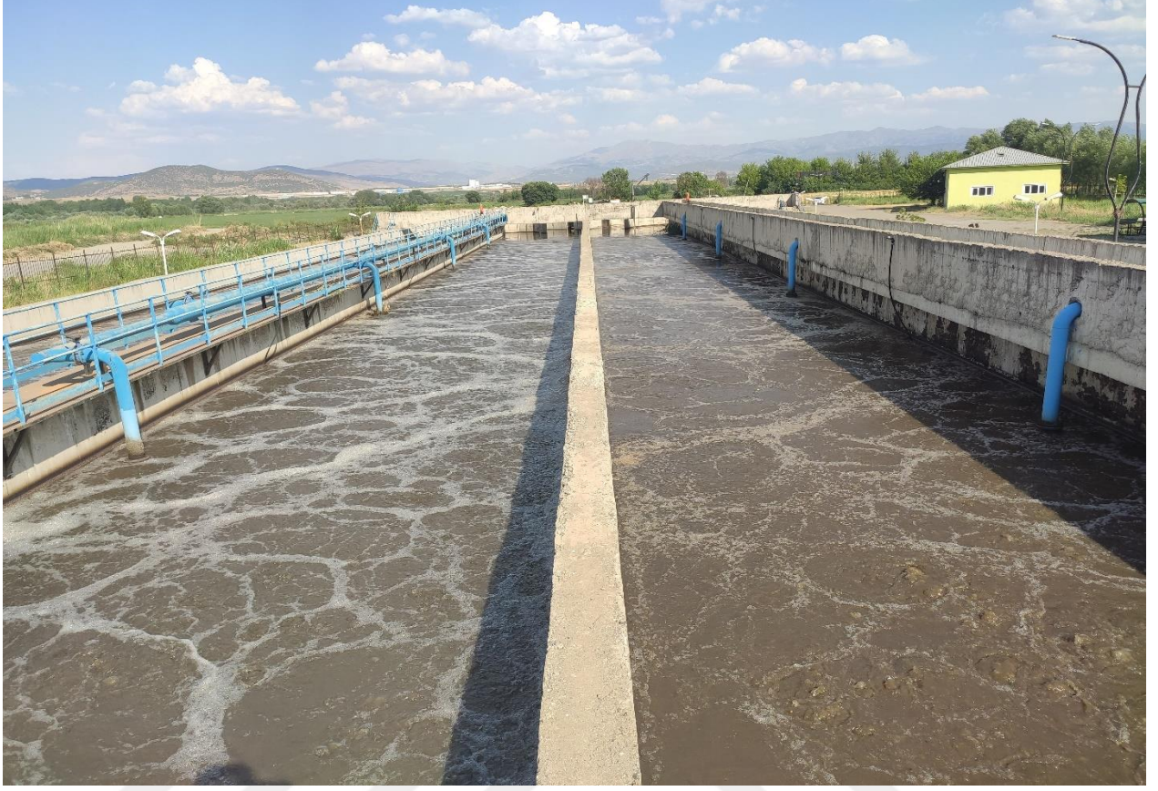
Şekil 3.6. Bingöl AAT Havalandırma Havuzu Genel Görünümü
