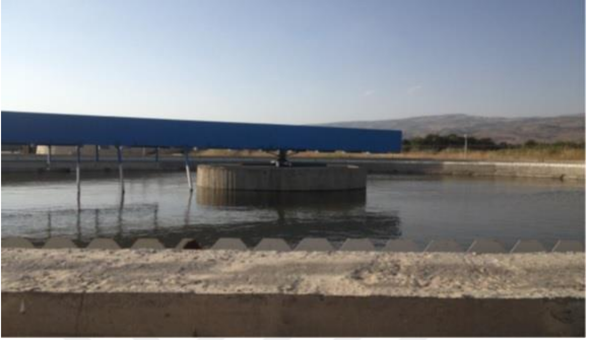
Şekil 3.7. Bingöl AAT Son Çökeltim Havuzu
