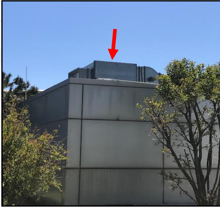
Resim 4.7. Merdiven basınçlandırma fanı damperi
