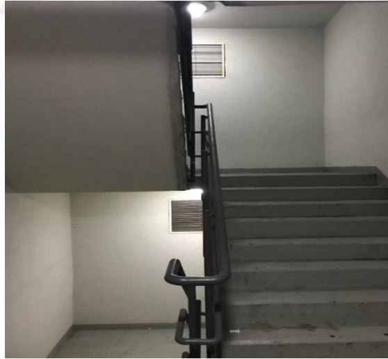
Resim 4.6. Yangın kaçış merdiveni ve merdiven basınçlandırma fanı
