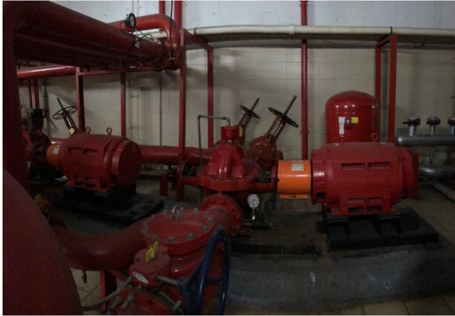
Resim 4.8. Elektrikli tahrikli yangın pompası
