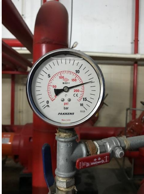
Resim 4.9. Yangın pompa odası basınç göstergesi
