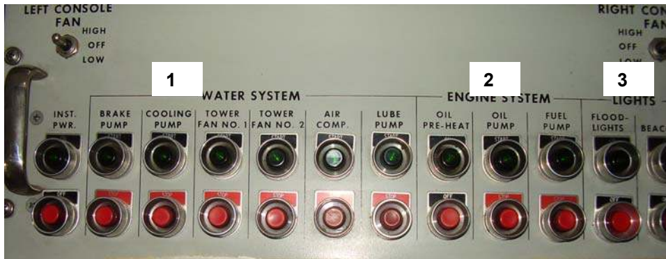
Şekil 3.8. Servis güç kontrol paneli
