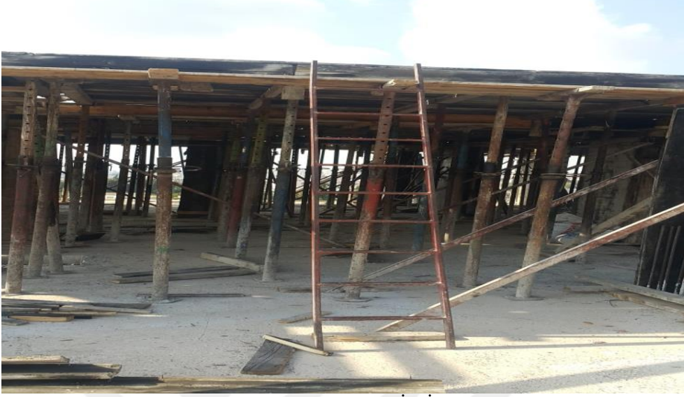
Şekil 4.8. Dayama Merdivenin Mevcut Durumu İle İlgili Resim
