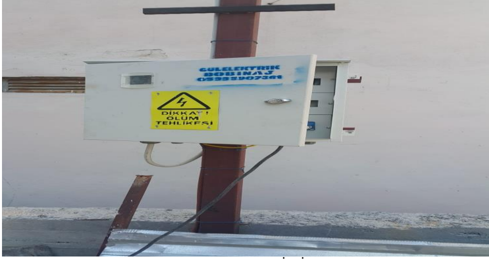
Şekil 4.2. Elektrik Panosunun Mevcut Durumu İle İlgili Resim
