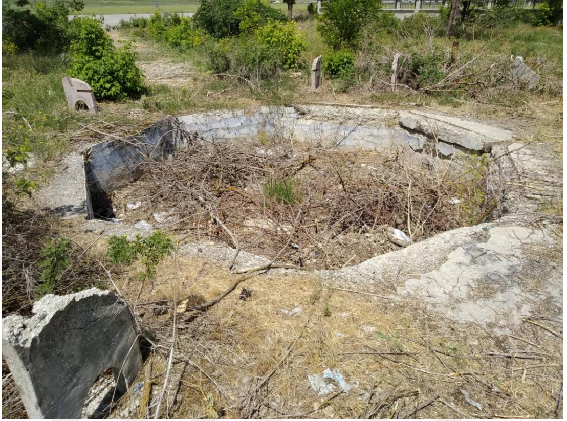
Resim 4: Pulur Köy Enstitüsü İdari Binasının Önündeki Havuzdan Kalan Harabe
