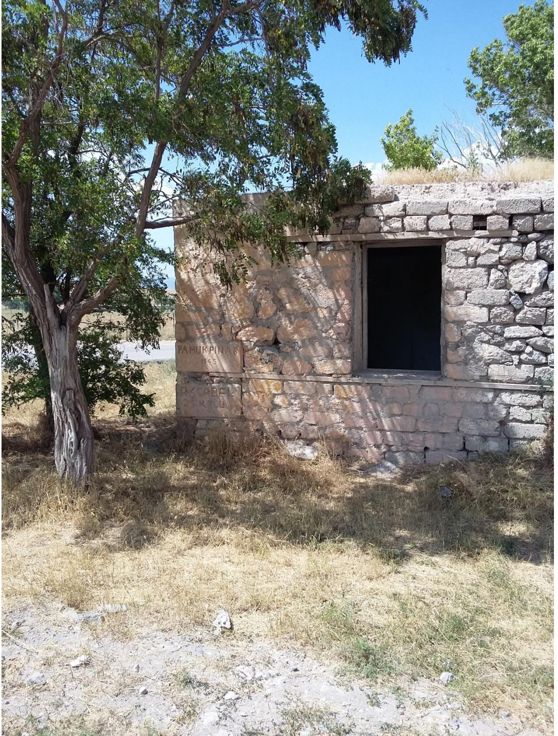
Resim 24: Enstitüden Kalan Bir Bina Harabesi
