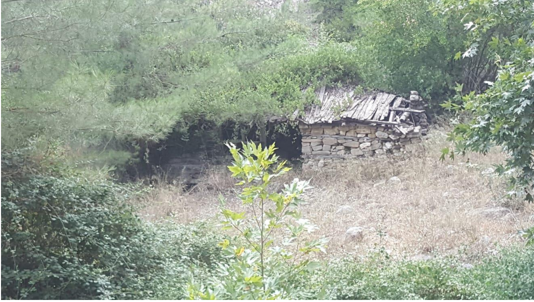
Fotoğraf 1.5 Eski Değirmen Yıkıntısı (Çatallar)
