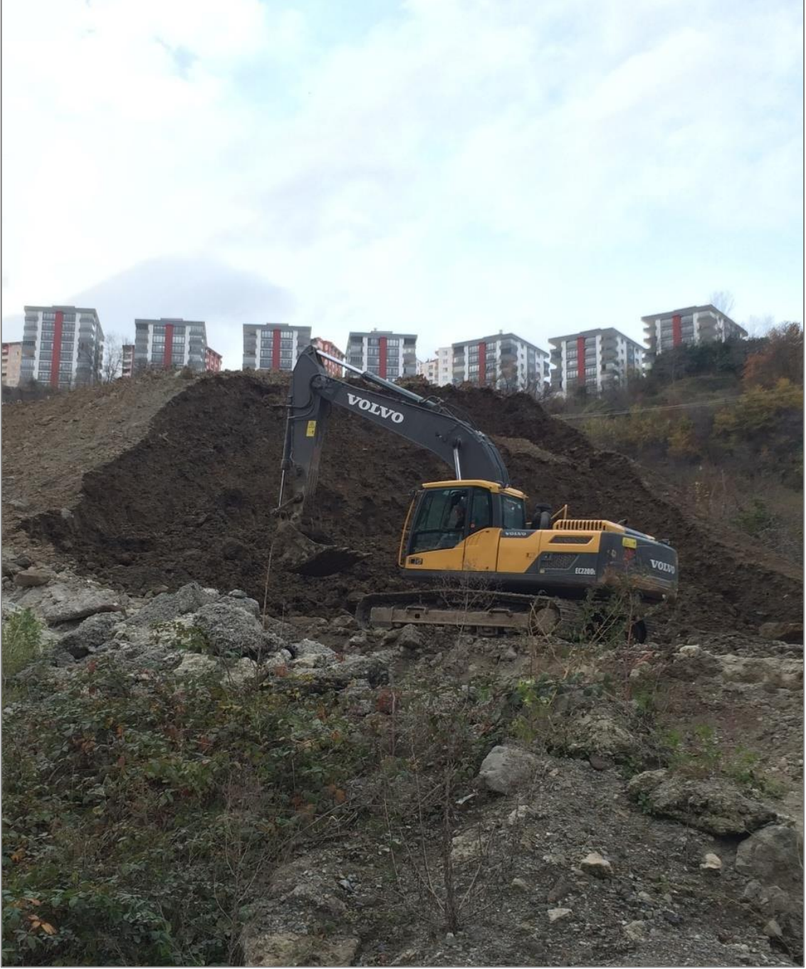
Şekil 2. Hafriyat alanının boşaltılması esnasında göçük olma riski
