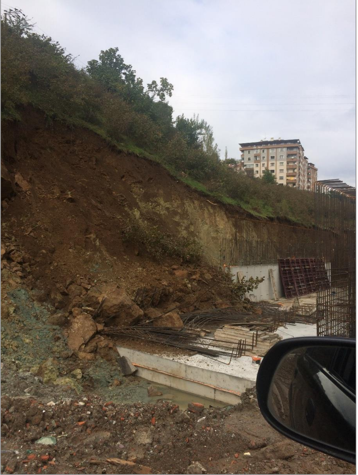
Şekil 4. Menfez inşaatı üzerine kayan toprak sonucu iş kazası
