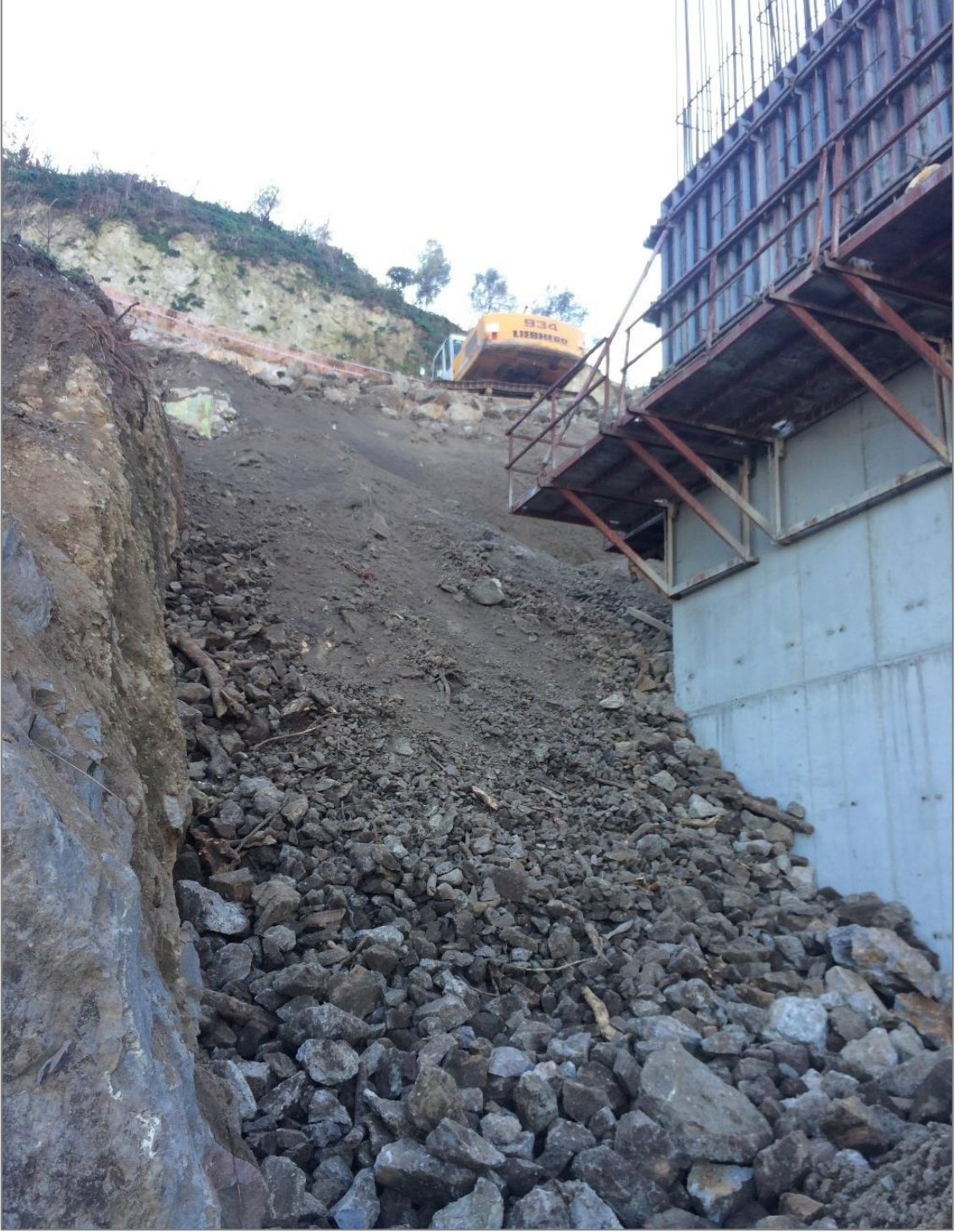
Şekil 6. Ayak temeli etrafından akan malzemenin ortaya çıkaracağı muhtemel riskler
