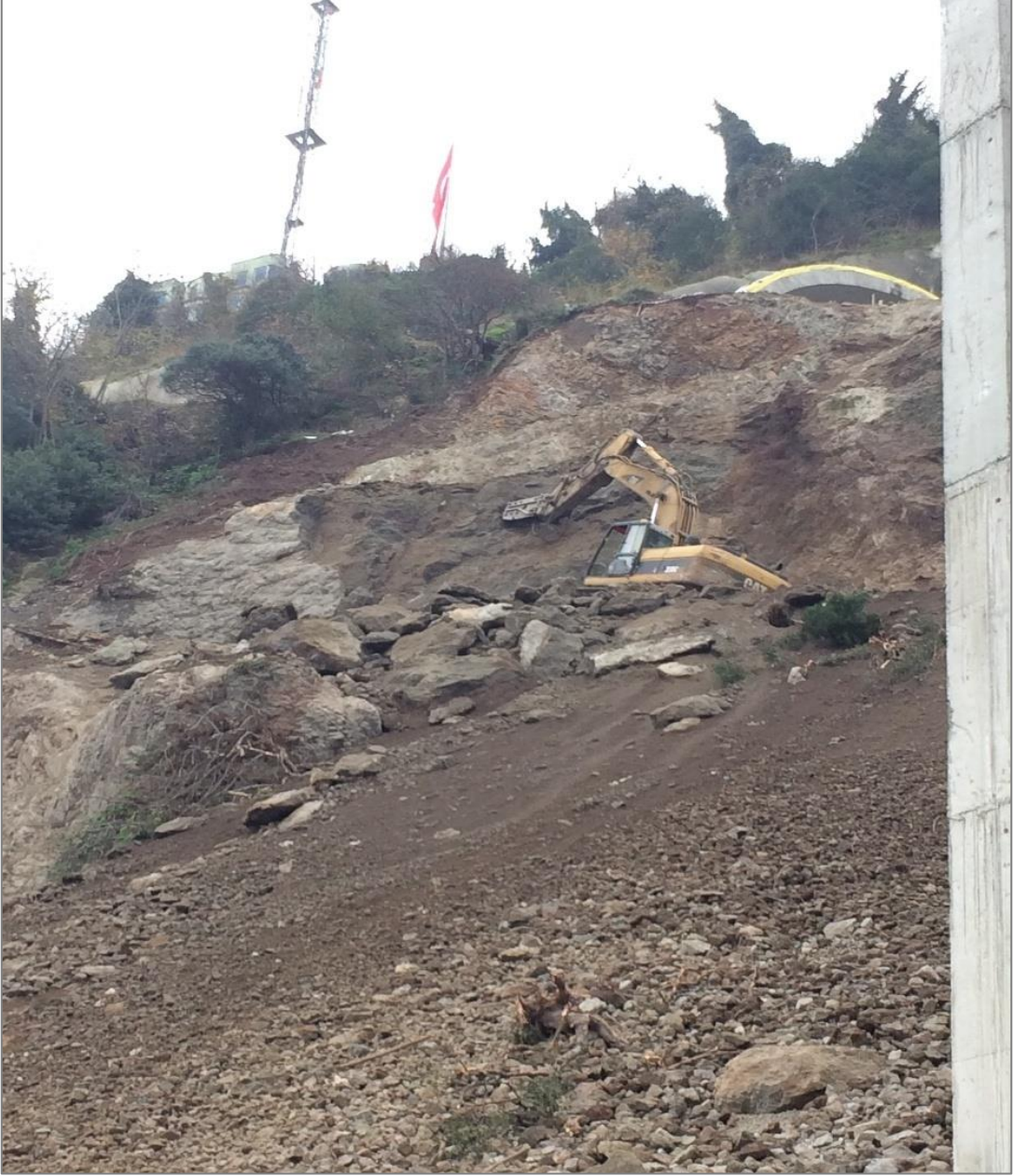
Şekil 3. Hidrolik kırıcı ile yol genişleme çalışması esnasında devrilme riski
