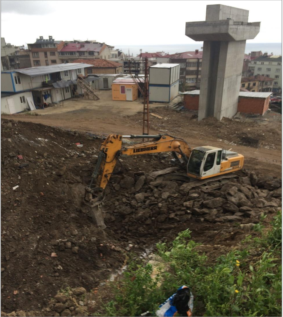
Şekil 5. Şantiye içi hidrolik kırıcı çalışması ve oluşması muhtemel riskler
