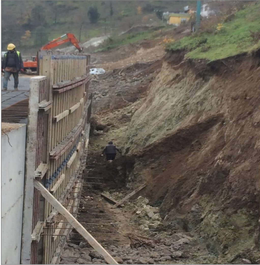
Şekil 1. Menfez inşaatı, duvar kalıbı ve zemin kazısı çalışması için ön görülen riskler
