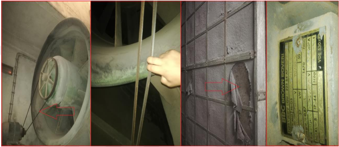
Şekil 4.6. İncelemesi yapılan klima sisteminden görseller.
