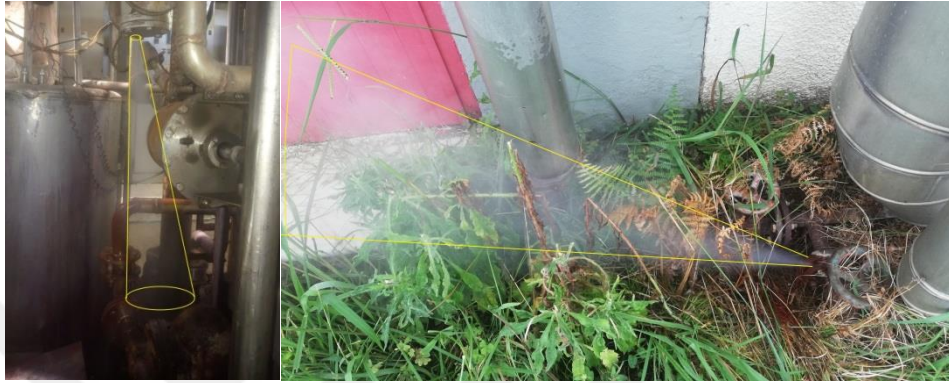
Şekil.5.3. Örnek buhar kaçakları fotoğrafı.
