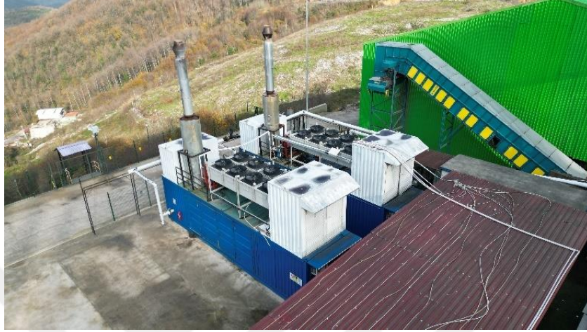
Şekil 6.2 konteyner tipi gaz motoru, Zonguldak.
