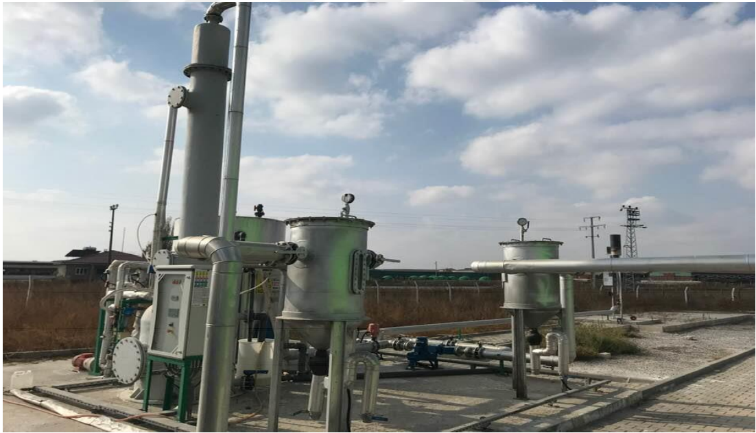
Şekil 2.10. Desülfürizasyon sisteminin görüntüsü
