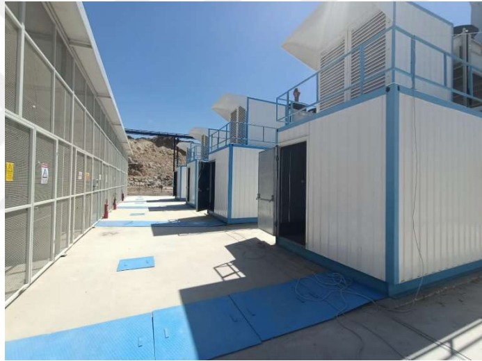
Şekil 3.21. Harmandalı DADT elektrik üretim alanı
