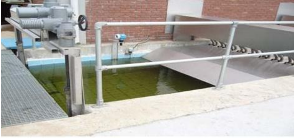
Şekil 2.5 : İnceleme Yapılan Atıksu Arıtma Tesisi UV ünitesi.
