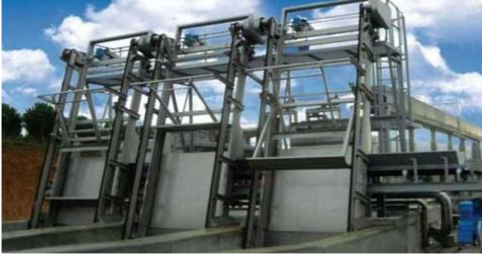
Şekil 2.4 : İnceleme Yapılan Atıksu Arıtma Tesisi ince ızgaralar.
