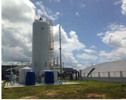
Görsel 2.9. Gaz arıtma ünitesi
