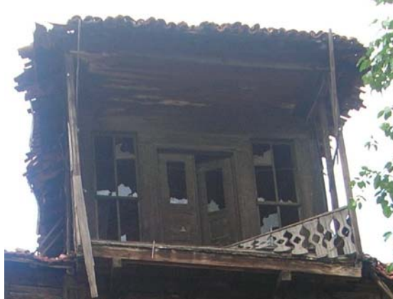
Fotoğraf 187:Yapıdan yıkılmış balkon korkuluğu
