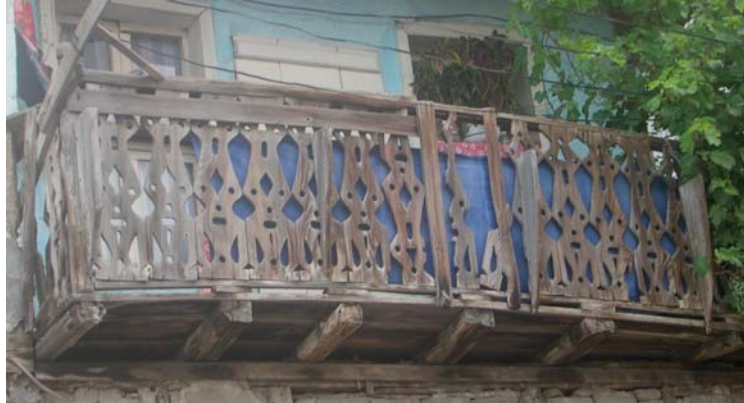
Fotoğraf 264: Yapıdan balkon korkuluğu örneği
