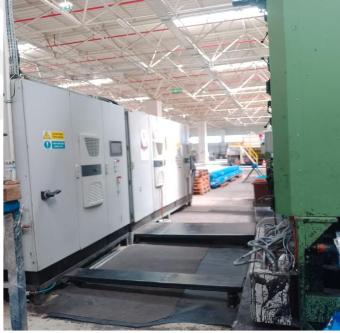
Şekil 3.21. Geogrid makinesi elektrik panosunu görünümü
