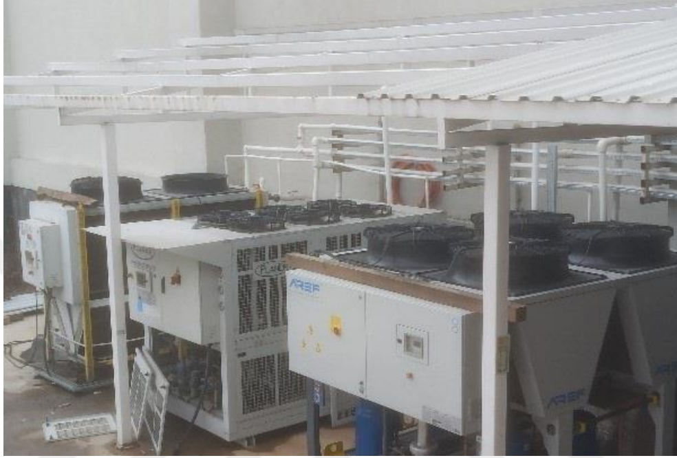
Şekil 2.11. Çiller soğutma sistemleri görünümü
