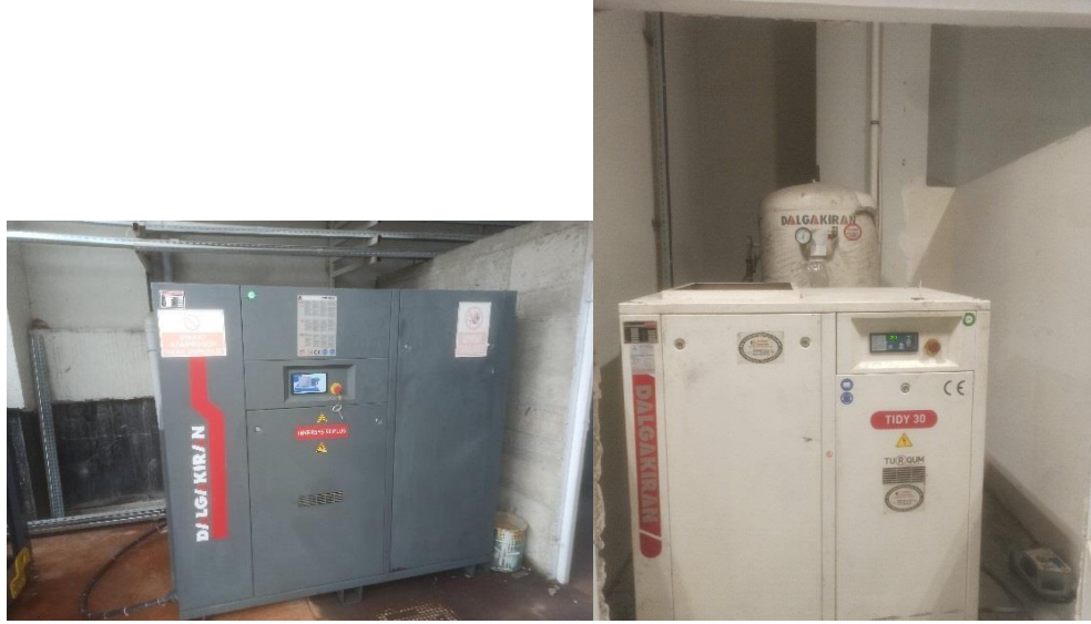
Şekil 2.12. Kompresör dairesi 1 ve 2'deki kompresörlerin görünümü
