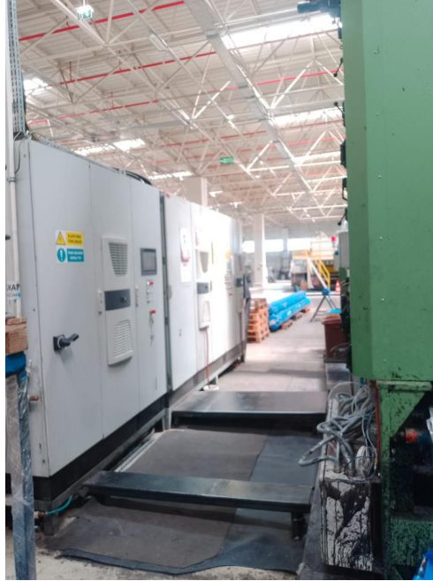
Şekil 2.10. Geogrid makinesi elektrik panosunu görünümü
