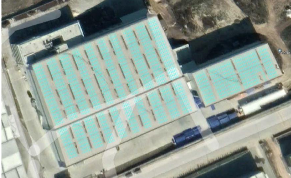
Şekil 3.23. 33 derece sabit panellerinin çatı yerleşiminin görünümü
