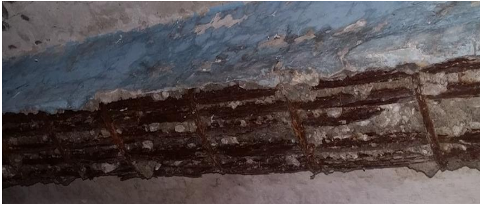
Şekil 3.1. Korozyon sonucu kiriş alt bölgesinde oluşan hasar (Erzincan, 2019).
