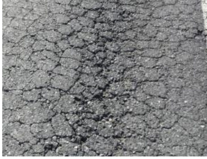
Şekil 24. Kaplamada meydana gelen timsah sırtı çatlaklar (URL-9, 2023)
