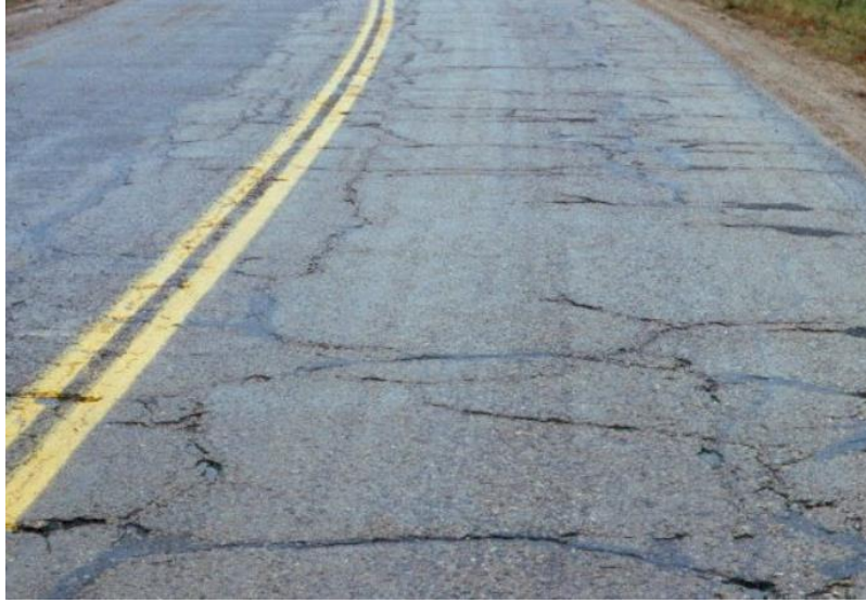
Şekil 25. Kaplamada meydana gelen düşük ısı çatlakları (URL-9, 2023)
