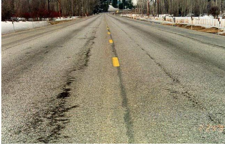
Şekil 26. Kaplamada meydana gelen sökülmeler (URL-9, 2023)
