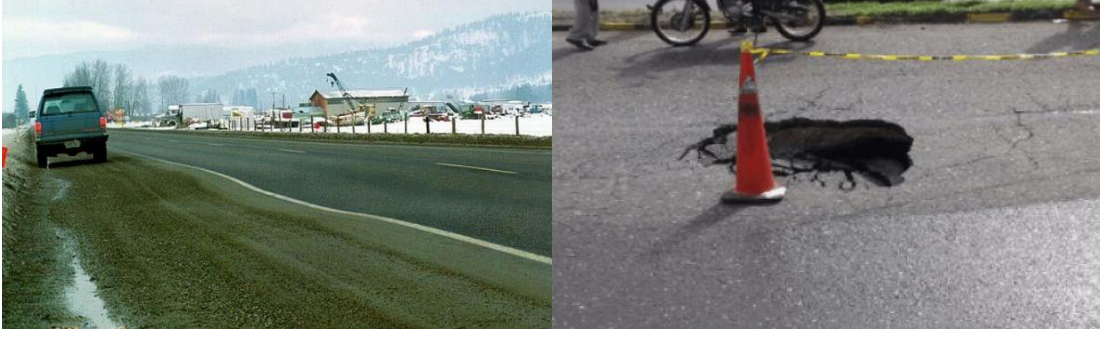
Şekil 22. Kaplamada meydana gelen (a) oturma ve (b) çökme deformasyonu (URL-8, 2023; URL-9, 2023)
