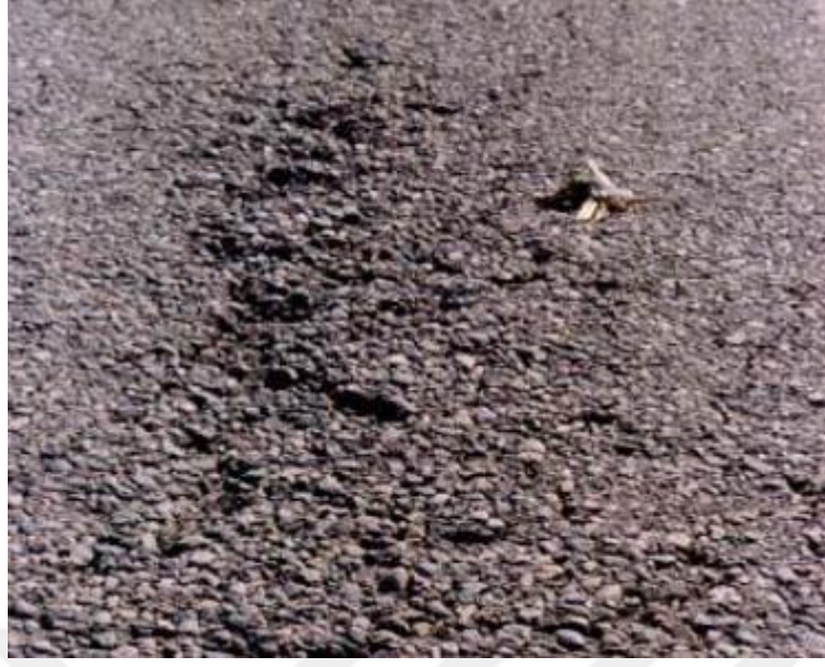
Şekil 27. Kaplamada meydana gelen soyulmalar (URL-9, 2023)
