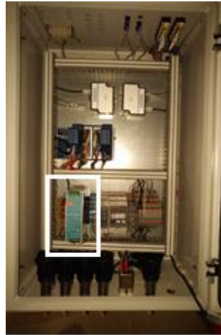
Şekil 2.24. Veri toplama sistemi güç kaynağı
