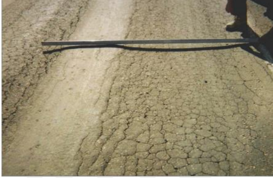
Şekil 20. Timsah sırtı yorulma çatlakları (Doğan, 2006)
