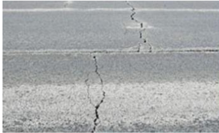
Şekil 21. Düşük ısı çatlağı (Yılmaz, 2016)
