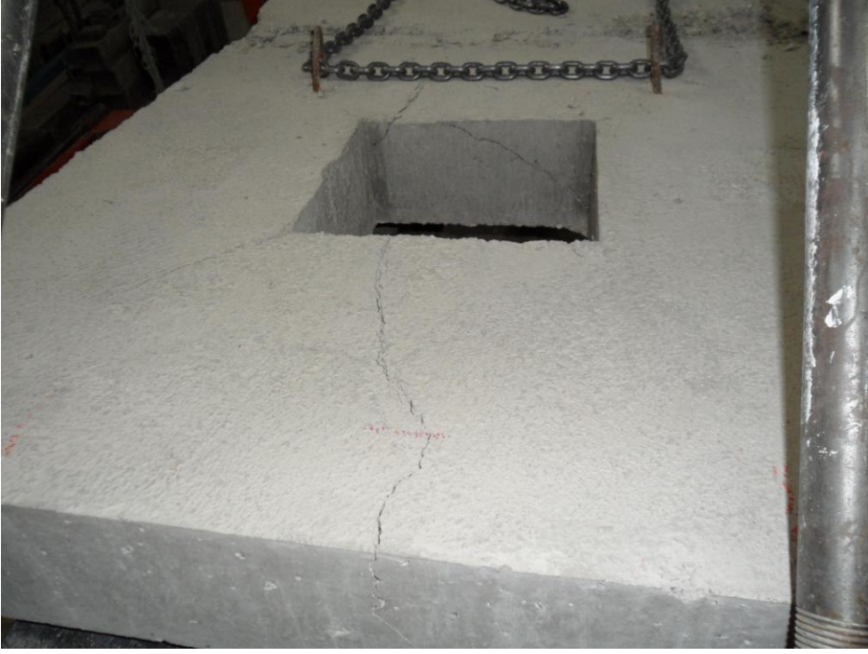
Resim 4.17. 7 numaralı elemanda boşlukta oluşan çatlaklar
