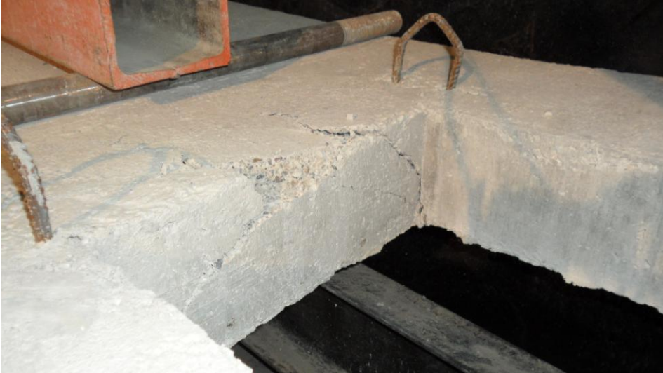
Resim 4.12. 5 numaralı elemanda boşlukta oluşan çatlaklar
