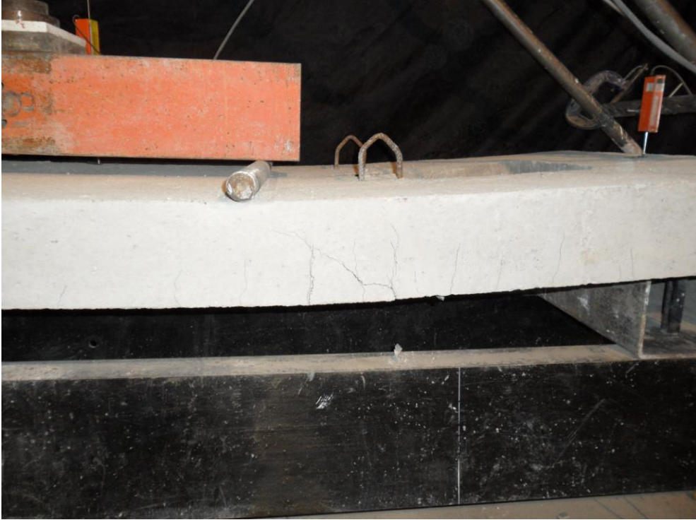
Resim 4.10. 5 numaralı elemanın eğilme çatlakları
