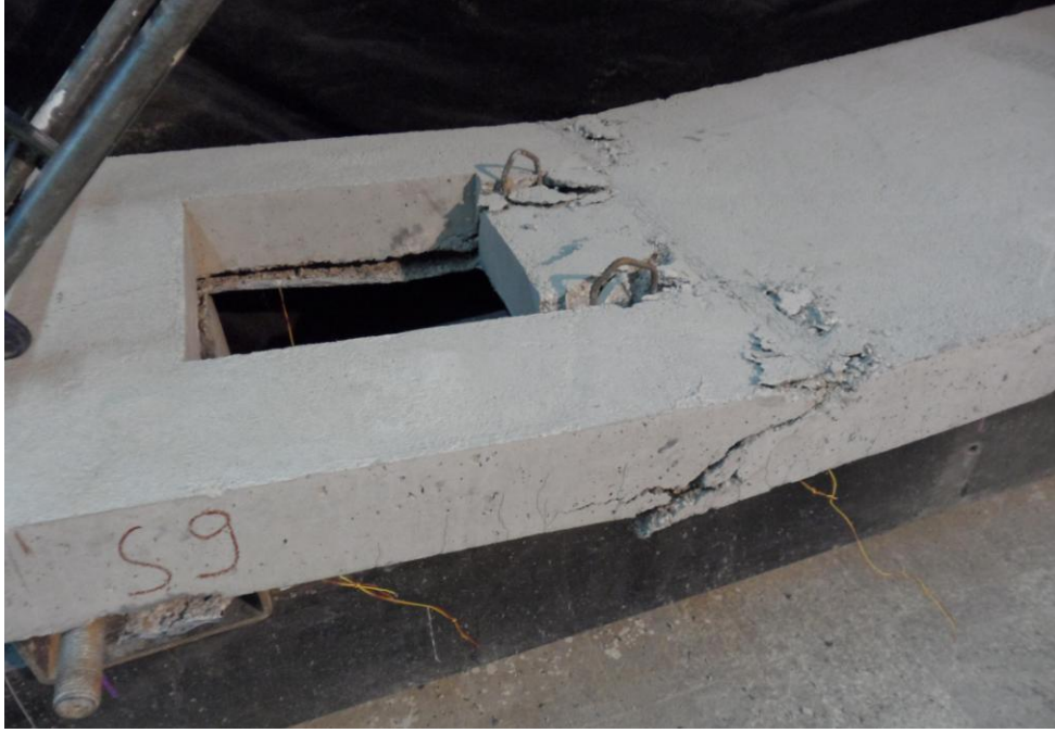
Resim 4.21. 9 numaralı elemanda oluşan kesme çatlakları
