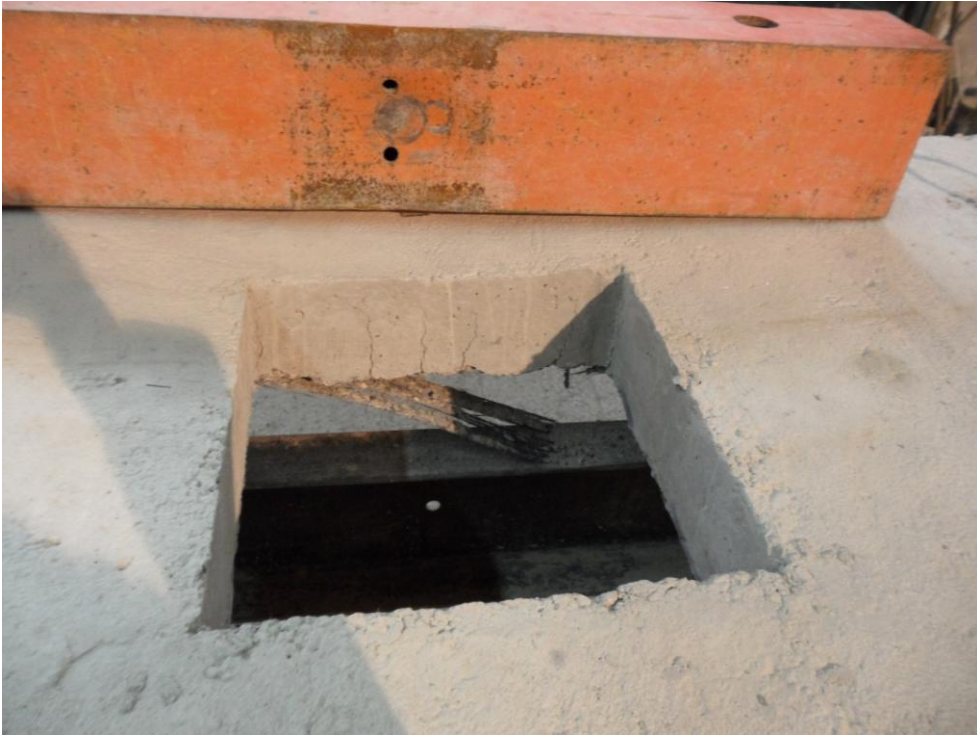
Resim 4.24. 10 numaralı elemanın eğilme çatlağı
