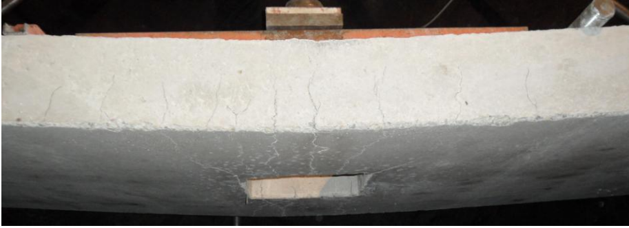
Resim 4.14. 6 numaralı elemanın eğilme çatlağı
