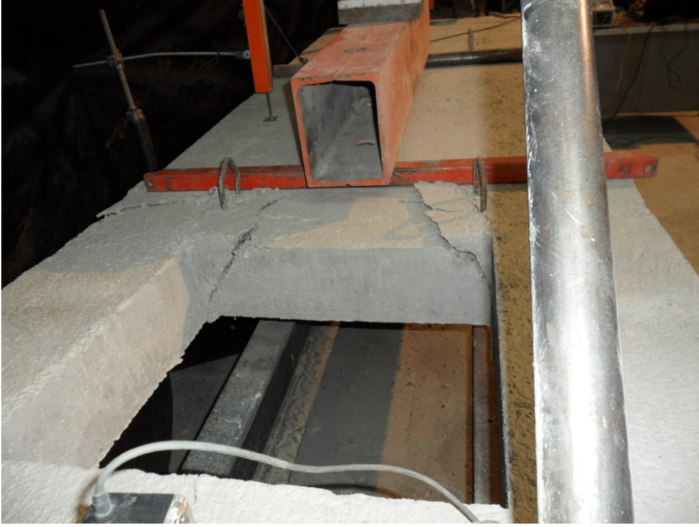
Resim 4.7. 3 numaralı elemanda boşlukta oluşan çatlaklar
