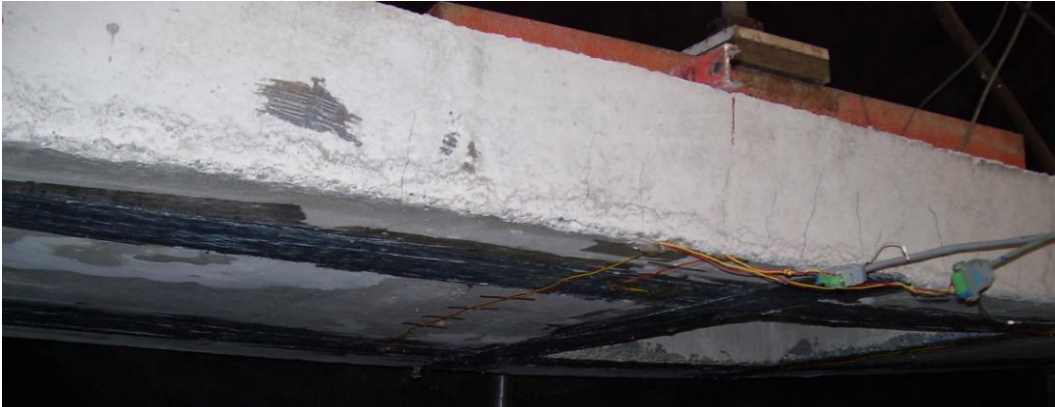
Resim 4.20. 8 numaralı elemanın eğilme çatlağı
