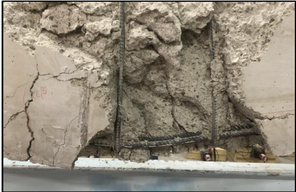
Şekil 4.69. K2-2 numunesi donatı akma bölgesi
