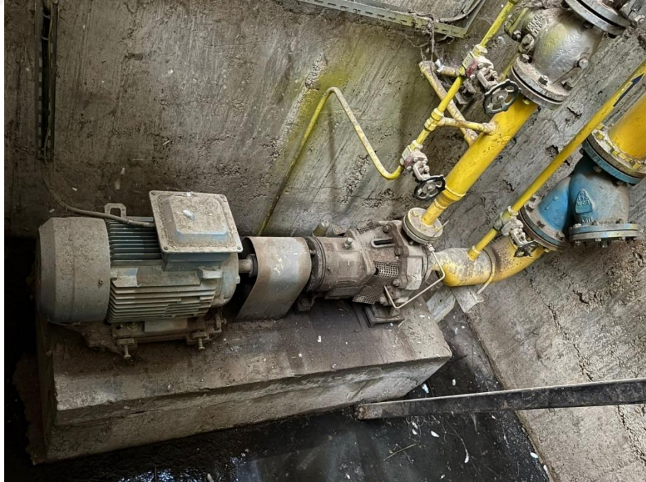
Şekil 13. Degazör besleme pompası
