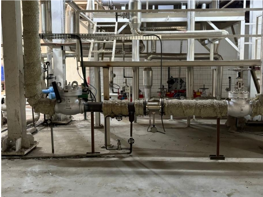
Şekil 15. Revizyon sonrası degazör ısıtma hattı
