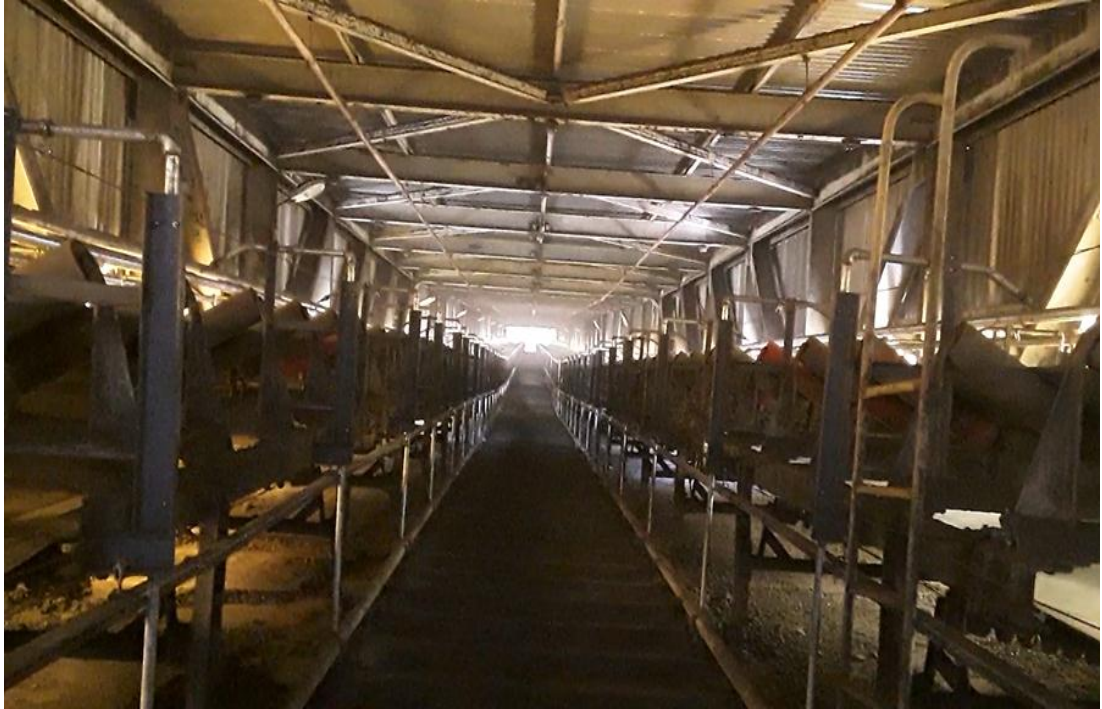
Şekil 3.2. Yeniköy rampa konveyörü
