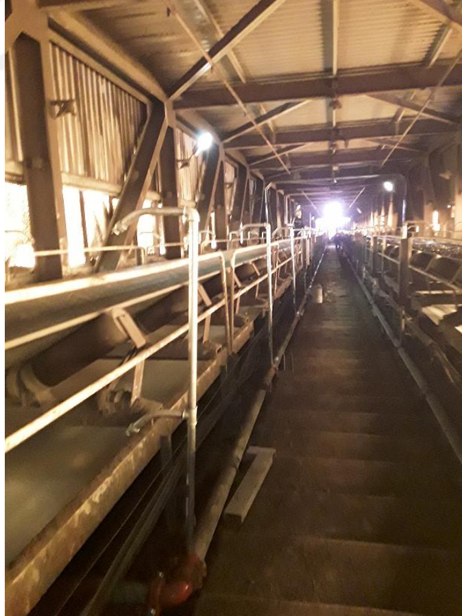
Şekil 3.1. Kemerköy rampa konveyörü
