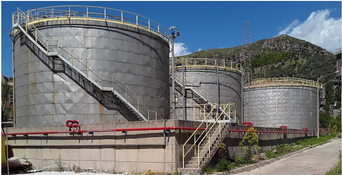
řekil 3.9. Fuel oil depolama tankı
